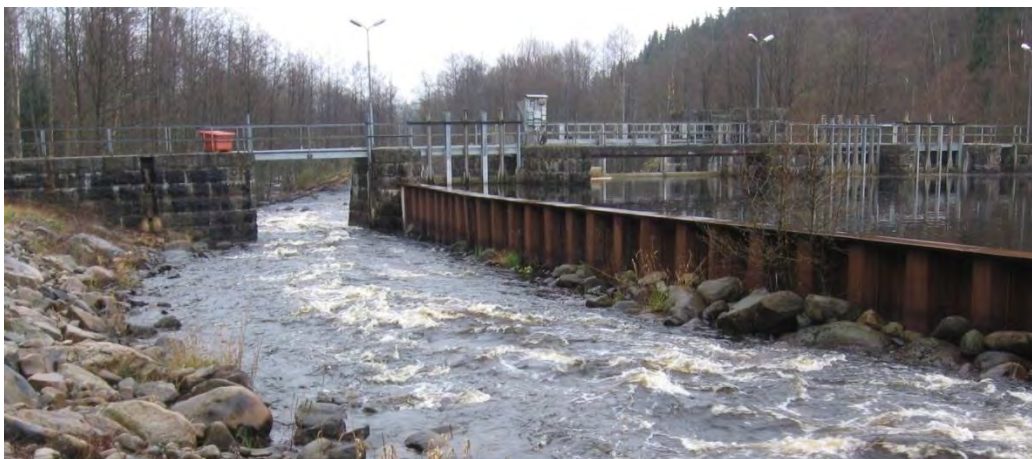
Figur 2. Inlöpet vid Hemsjö nedre kraftverk i Mörrumsån. (foto: Niklas Nilsson, Jönköpings Fiskeribiologi AB).
