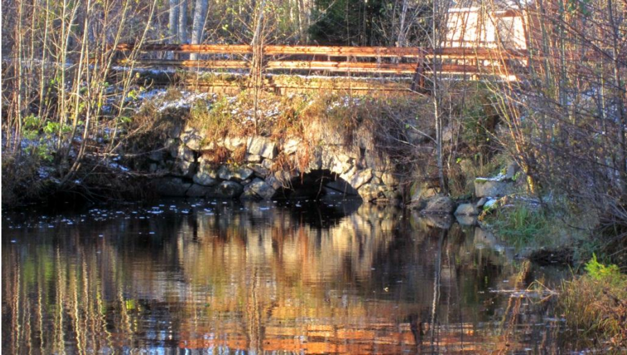
Delvis överdämd stenalvsbro byggd av kilade tuktade stenar. Bron är belägen i västra änden av Lilla Klerebodammen/Hulebodammen.
