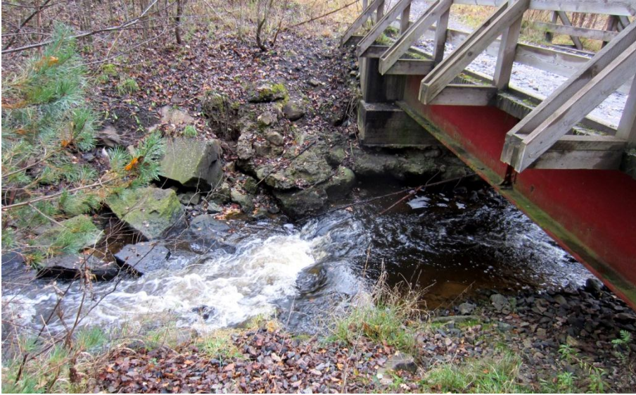
Rester av den utrivna Sjöåkradammens fördämningsmur under gångbron. Foto från N.
