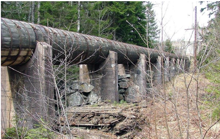
Vattentub från Fjällbölsdammen. Flera generationers tubstöd. Foto från SÖ.
