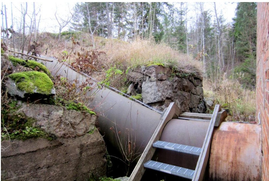
Stenmur (senare förstärkt med betong) till Klerebo kvarn här genombruten av vattentuben till Klerebo kraftstation. Foto från SÖ.
