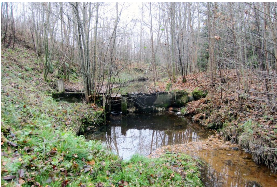
Två fördämningar av betong i Lillåns östra gren nedströms vägbron till Kolaryd. Bilden visar den nedre fördämningen. Foto från N.
