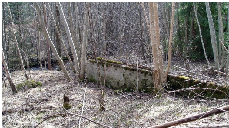
Gjuten grund efter det påbörjade, men aldrig avslutade kraftstationsbygget vid Slätten, Svedån. Foto från SV.
