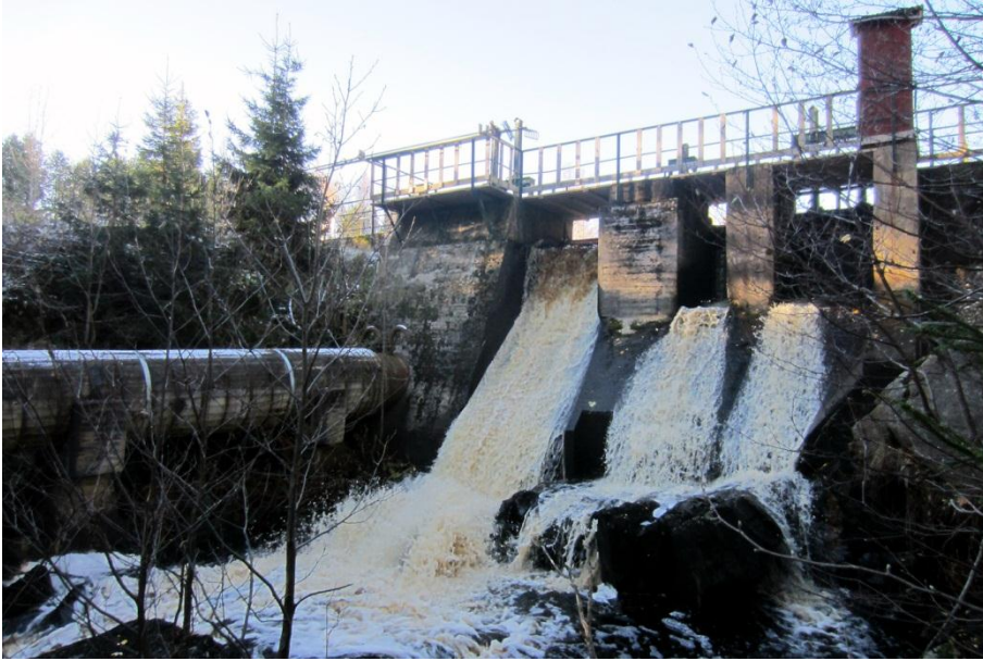
Fördämningen till Lilla Klerebodammen/Hulebodammen. Dammluckor öppna vid fyllda vattenmagasin. Tuben leder drivvatten till Hulebo kraftstation. Foto från N.
