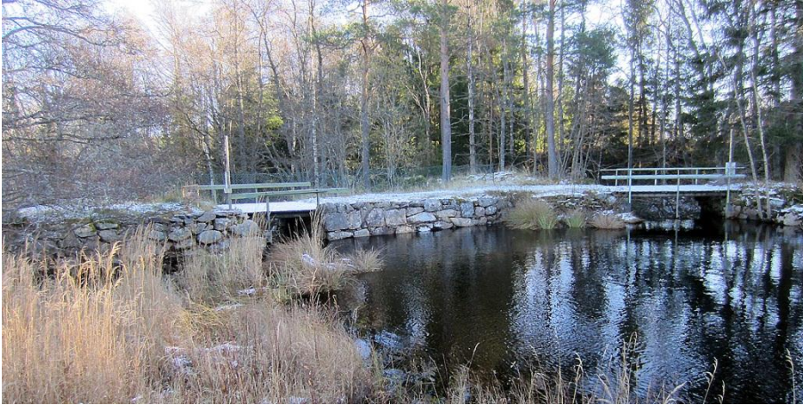
Kvarndamm vid Rödjestugan. Välbyggd och välbevarad fördämningsmur av sten. Dammöppningarna förstärkta med betong. Två dammöppningar för kvarn till vänster (N), såg till höger (S). Foto från VNV.
