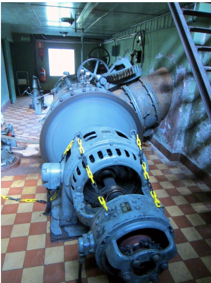
Turbin i Aledals kraftstation.
