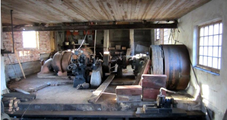
Kraftstationen i Källebacken från omkring 1930-talet. Maskinhuset inrymmer två Francisturbiner.
