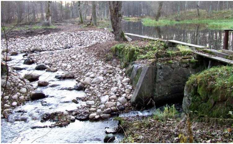
Gamla kvarnplatsen med fördämning, damm, Månseryd. Fiskevårdsåtgärder vidtagna i form av anläggande av omlöp förbi dammfallet. Foto fr. Ö.
