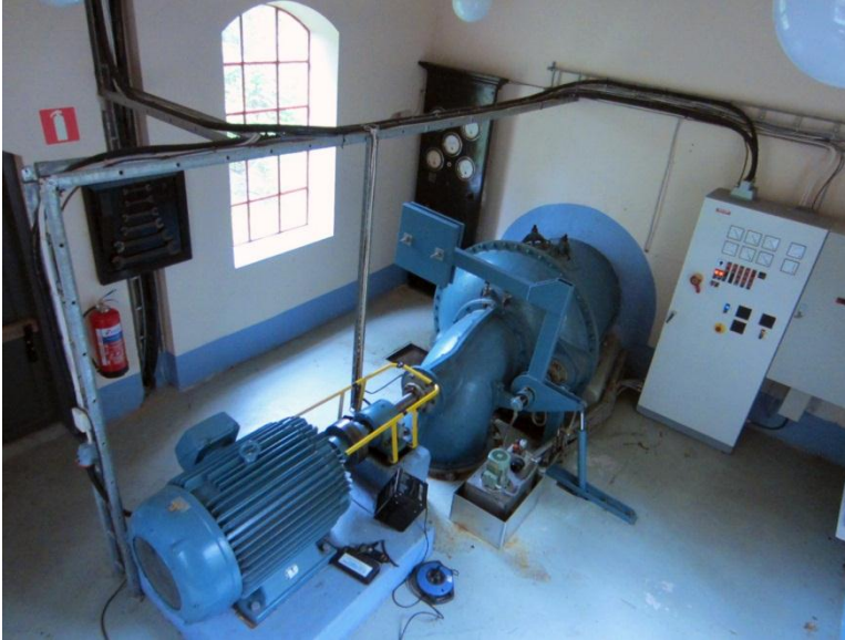
Turbin i Klerebo kraftstation. Maskinrummet inrymmer en enhjulig Francisturbin av frontaltyp. Den gamla instrumenttavlan finns bevarad till vänster om turbinen.
