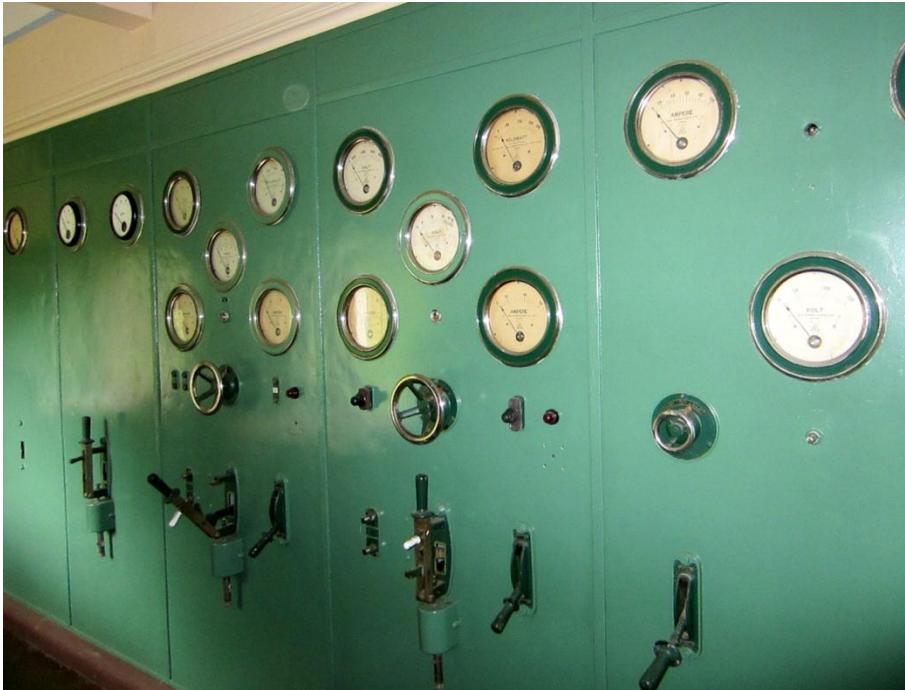
Gamla instrumenttavlan bevarad i Hulebo kraftstation.
