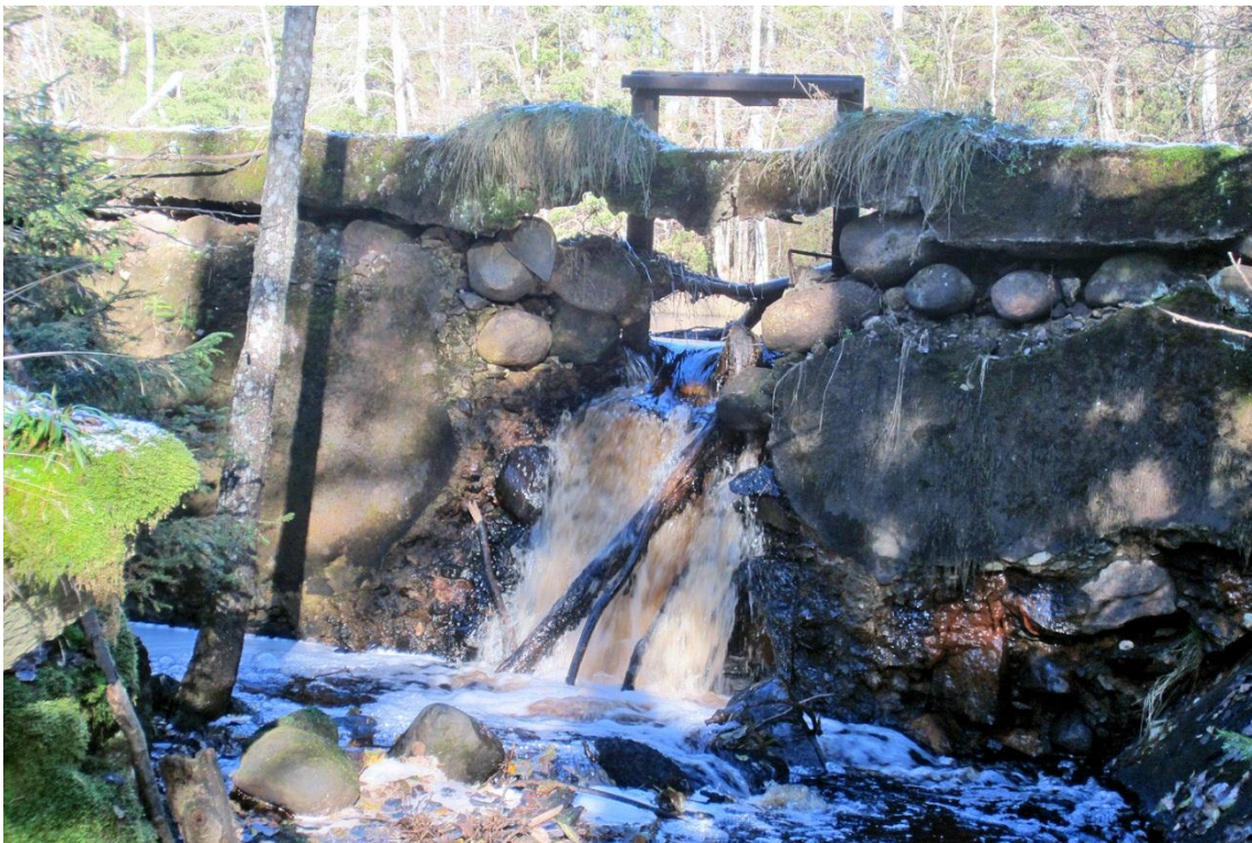
Fördämningsmur, Lindhultsdammen. Dammöppningen utsatt för erosion. Foto från S.
