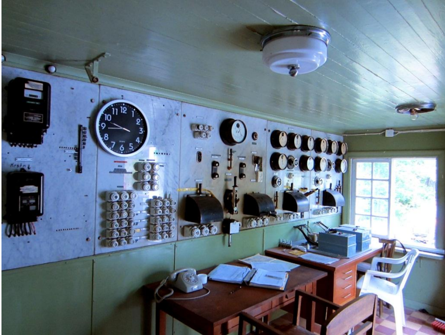
Gamla instrumenttavlan i Aledals kraftstation.
