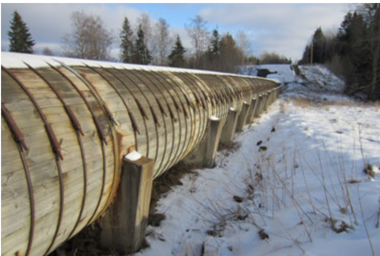
Tub av liggande träribbor sammanbundna med järnband. Tuben för drivvattnet över en sänka från en nivåkanal (syns i bakgrunden) till en annan med uppsamlingsdam och vidare i tub till Ramsjöholms kraftstation. Foto 2012, från V.
