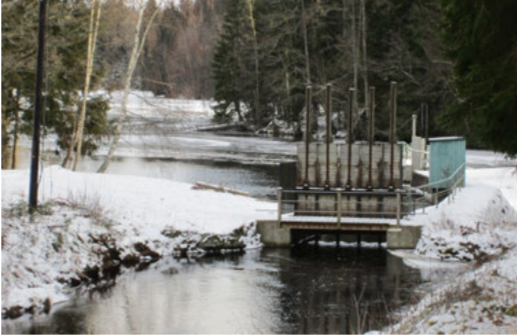
Ramsjöholms kraftverksdam. Nivåkanal i förgrunden. Härifrån regleras och leds vattnet till Ramsjöholms kraftstation längs en 900 meter lång sträcka. Foto 2012, från NV.
