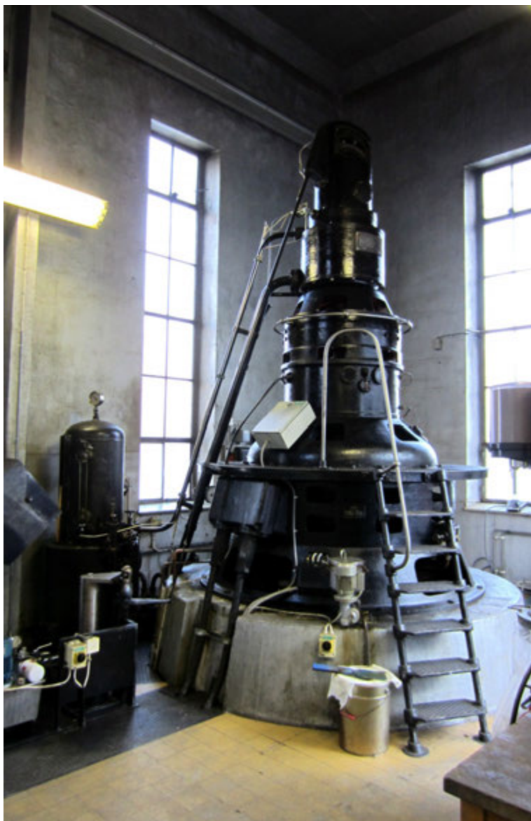
Kaplanturbin i kraftstationen till Carlfors Bruk. Tillverkad av Nyqvist & Holm NOHAB i Trollhättan. Installerad 1936–1937.
