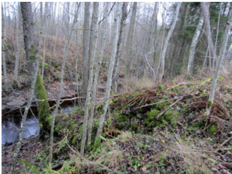
Osäker fördämningmur. Kraftigt övermossad. Foto från SV.
