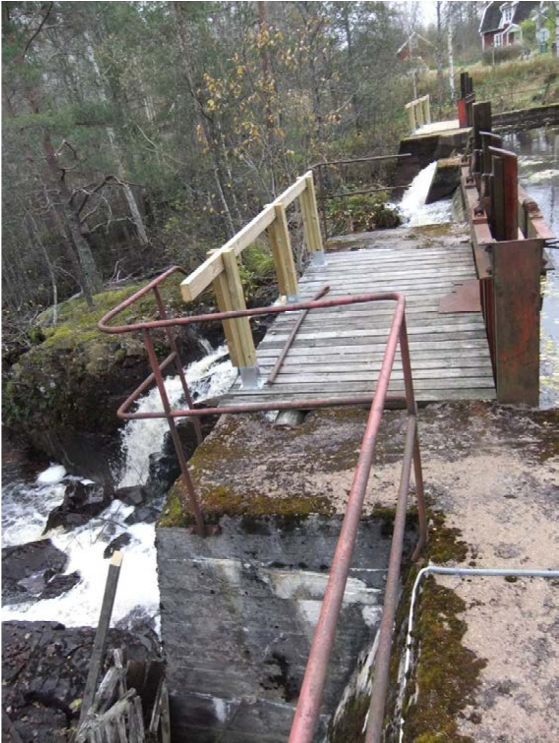
Figur 155. Bruzaån 92, dammvallen som under hösten år 2012 genomgick vissa reparationer och förbättringar. Den totala fallhöjden på åtta meter gör det omöjligt för öring att vandra förbi det totala hindret. Tidigare fanns här en teknisk fiskväg eller trappa som eventuellt planeras tas i drift igen.
