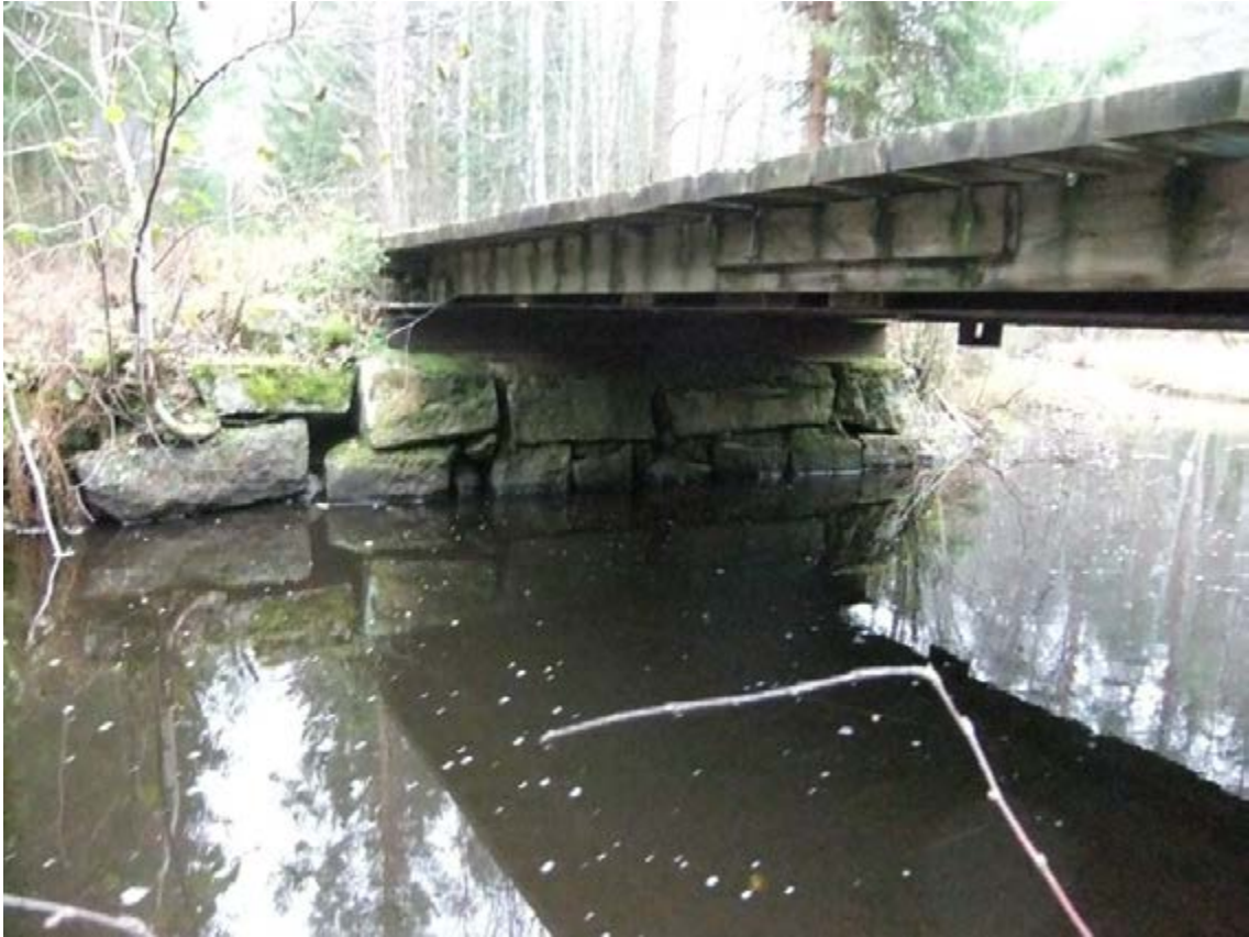
Figur 337. Brons södra fäste, av äldre hävd sedan 1700-talet enligt äldre kartor, säkerligen renoverad och reparerad i omgångar under modern tid. Fotot är taget från nordöst.
