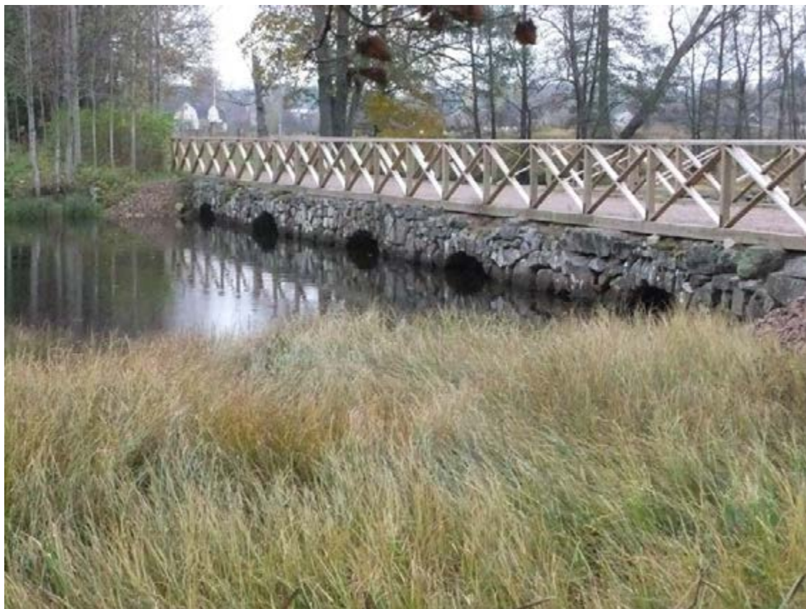
Figur 166. Bruzaån 97, den gamla stenvalvsbron i Mariannelund som den såg ut år 2011. Träräcket och förstärkningar vid brofästena är mer moderna inslag i bronns historia men återanknyter till hur de sett ut innan. Bron ligger i ett utsatt läge när översvämningar äger rum i Bruzaån, återkommande reparationer kan därför vara nödvändiga. Bron härstammar sannolikt i 1700-talet. Fotot är taget från nordöst.
