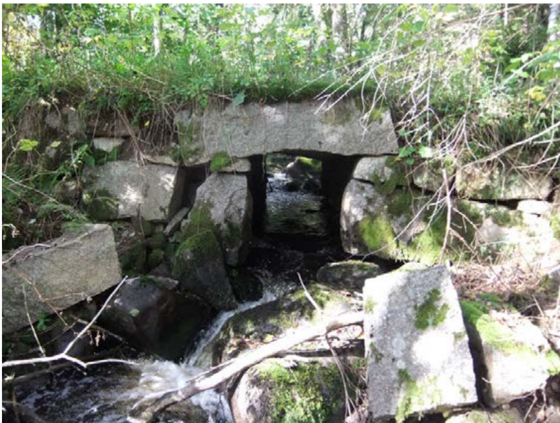
Figur 115. Bruzaån 61, en enkel stentrumma eller rektangulärt slaget stenvalvsbro. Bron eller broplatsen har anor i 1700-talet och kanske ännu äldre. Fotot är taget från sydöst.
