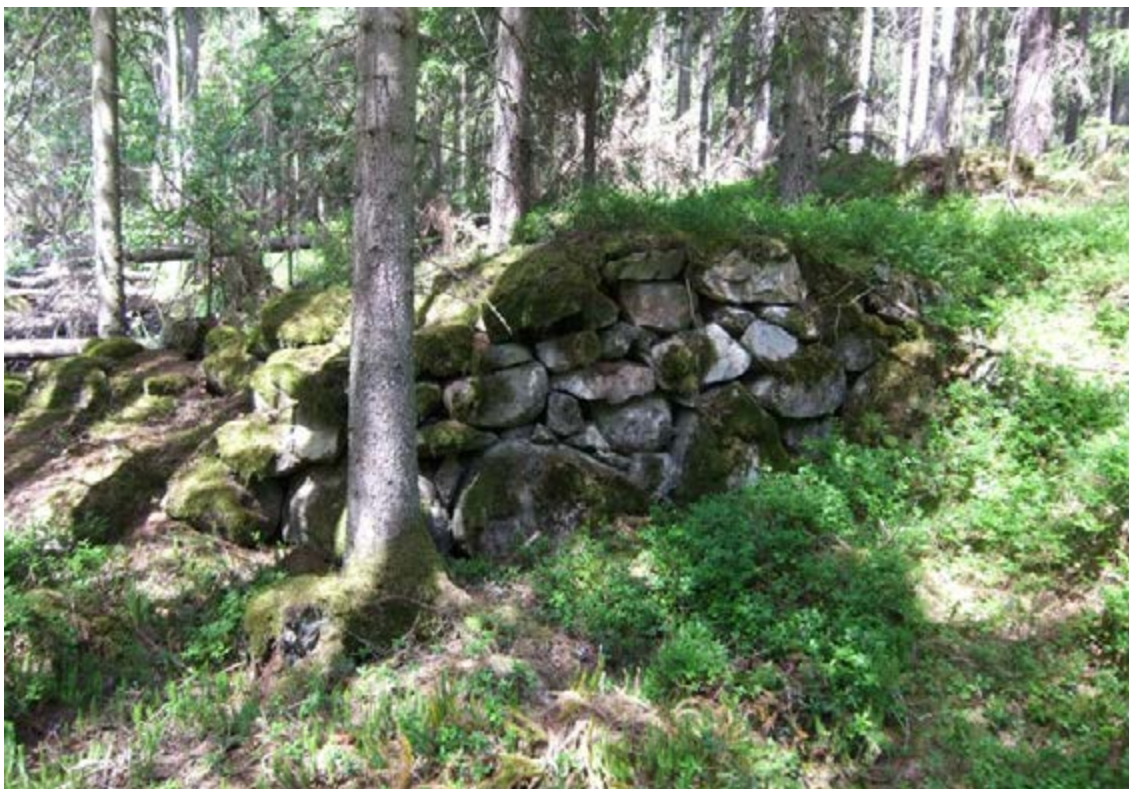
Fig 376. Sällevadsån 15. Dammvallens norra del, uppbyggd med kallmurad natursten. Fotot är taget från sydöst.
