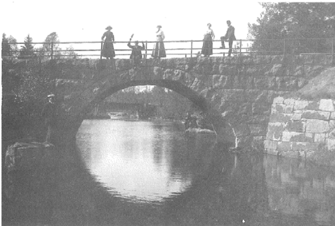
Figur 150. Bruzaån 89, den västra sektionen, då bron var relativt nybyggd i början av 1900-talet. Fotot är hämtat ur Pettersson 2000, sidan 47. Fotot är taget från nordnordöst av Adrian Johansson år 1916.
