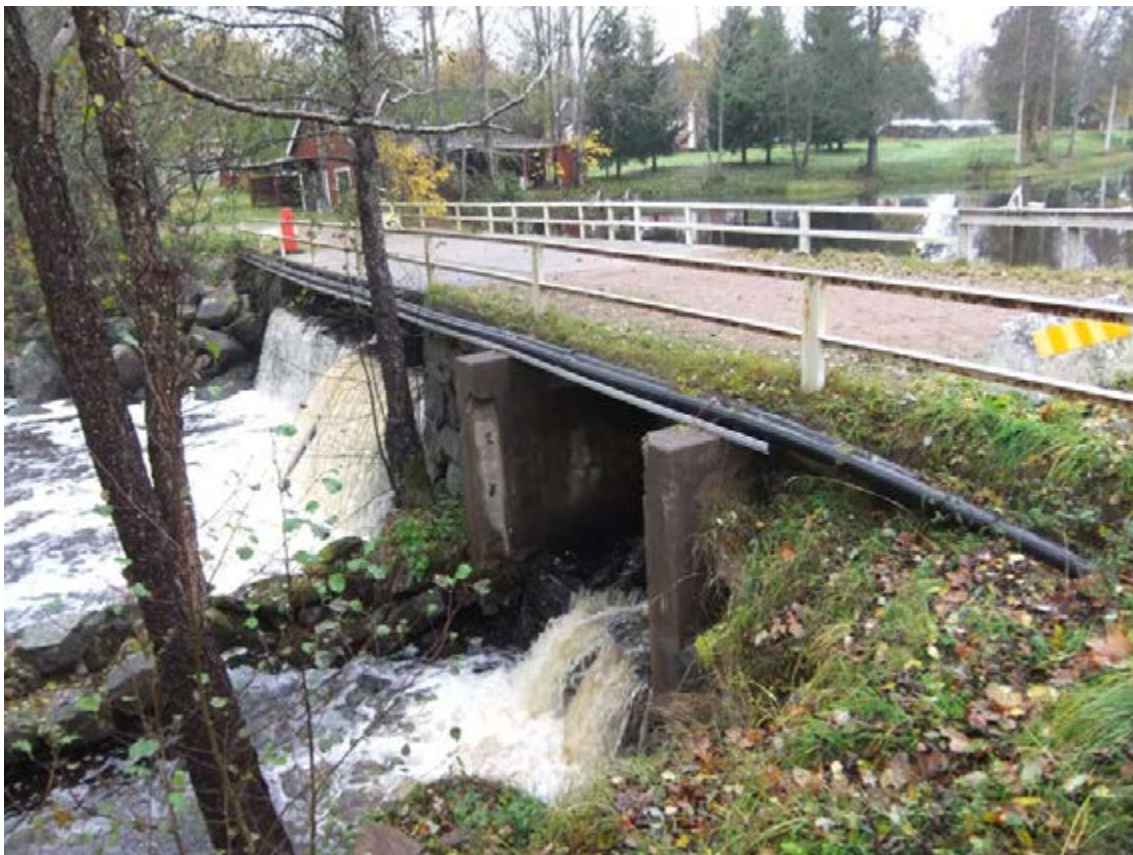
Figur 183. Bruzaån 102, dammvall och bro idag. Närmast ett utskov som leder vatten till den gamla kvarnfåran. Fotot är taget från östnordöst.
