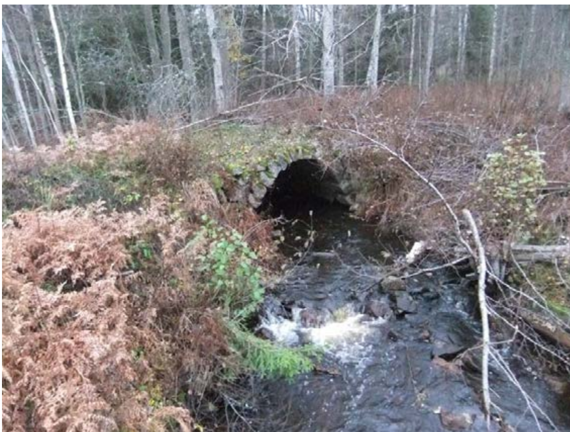
Figur 322. Gnyltån 18, stenvalvsbron, Ökna 34:1, klassad som fast fornlämning och skyddat enligt Kulturmiljölagen. Bron är med i åtgärdsförslagen för Gnyltån, men inte klassad som vandringshinder. Föreslagna åtgärder innebär manuell justering av fallprofilen i åfåran. Fotot är taget från sydöst. Eventuellt kan ännu äldre föregångare till bron finnas strax intill i form av fundament. Vägövergången syns på flertalet äldre kartor.
