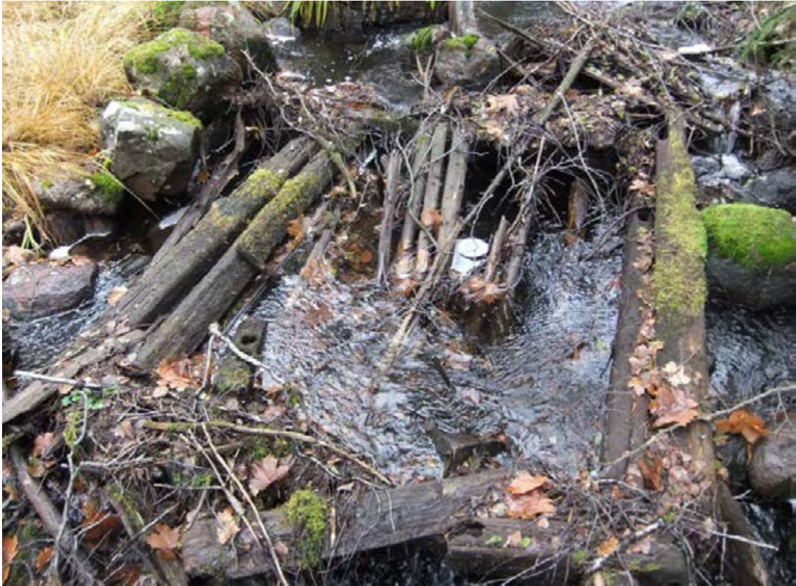
Figur 289. Ålkistan sett snett ovanifrån. Överbyggnaden har rasat ihop, Endast enstaka detaljer återstår. Fotot är taget från östsydöst.
