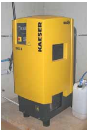
Ny kompressor som var anpassad efter behovet sänkte förlusterna
