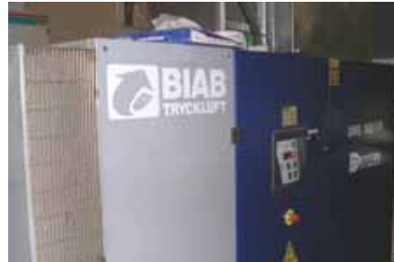
Ny kompressor som är anpassad efter behovet
