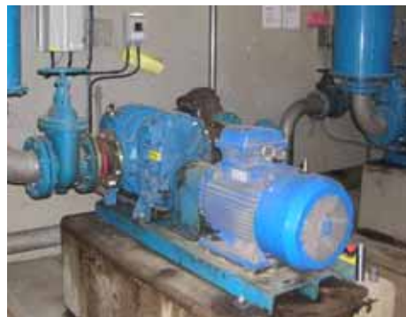
Nya motorer till blåsmaskinerna sänkte elförbrukningen.
