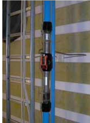
Luftmätare för att upptäcka läckor på tryckluftssystem
