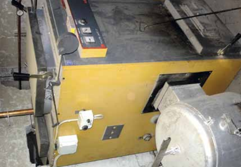
Flispannan som står för gårdens hela värmebehov samt varmvatten vintertid.
