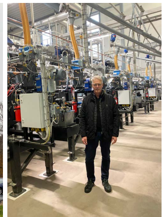
Staffan Eklöv inne i centralen vid pannorna.
