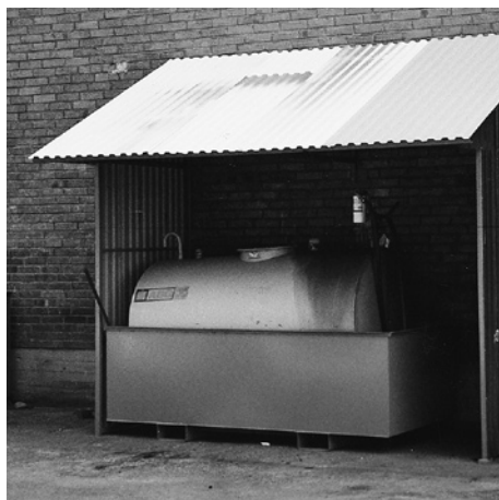
Invallad cistern med tak för förvaring av diesel. Bilden är tagen hos Motala Verkstad AB
