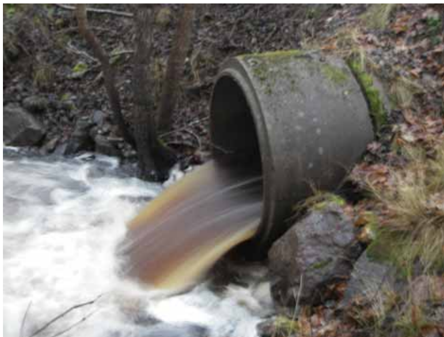
Vägtrumma med fall på nedströmssidan som hindrar fisk och smådjur att simma uppströms – ett vanligt miljöproblem.
