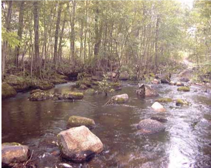
Exempel på vattendrag där block och sten hade rensats och lagts på land. Med hjälp av grävskopa återfördes blocken ned i vattnet vilket gav ökade förutsättningar för bottenfaunan och ökad mängd gömslen för fisk.
