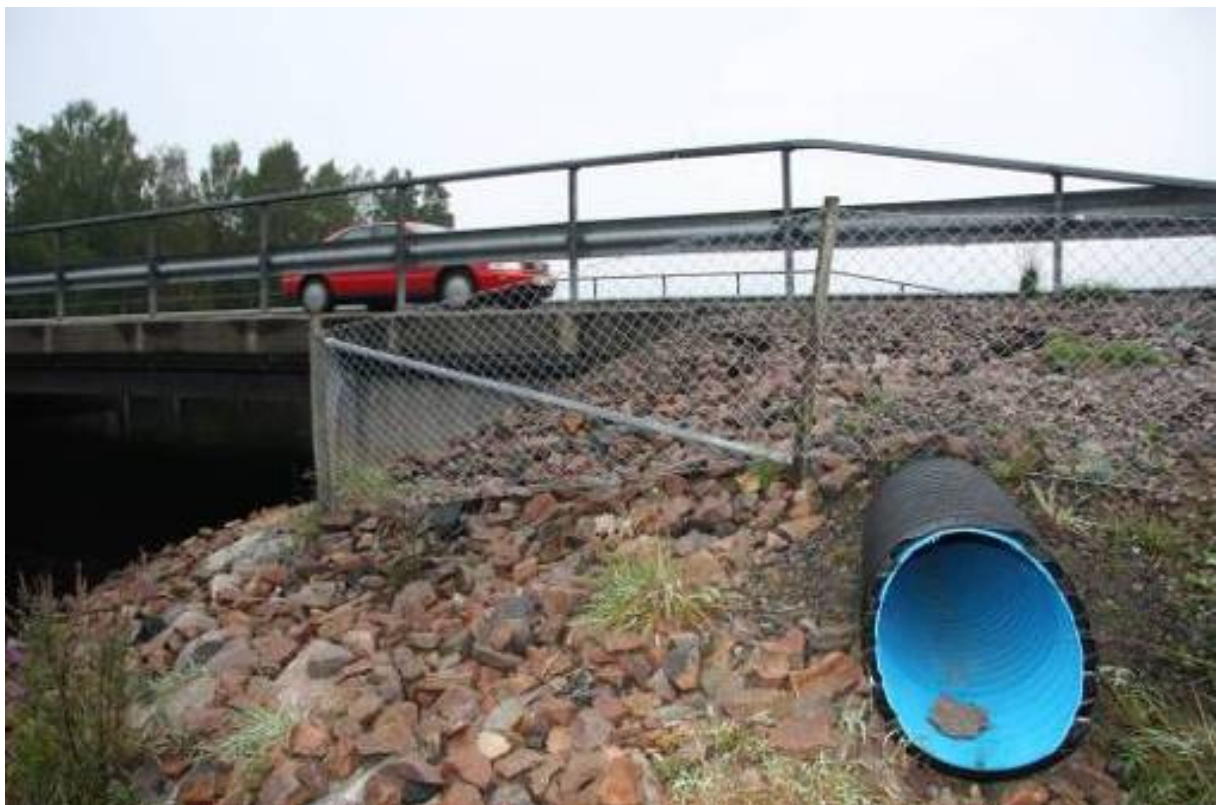
Figur 9. Utterpassage med hjälp av ”torrtrumma”.
