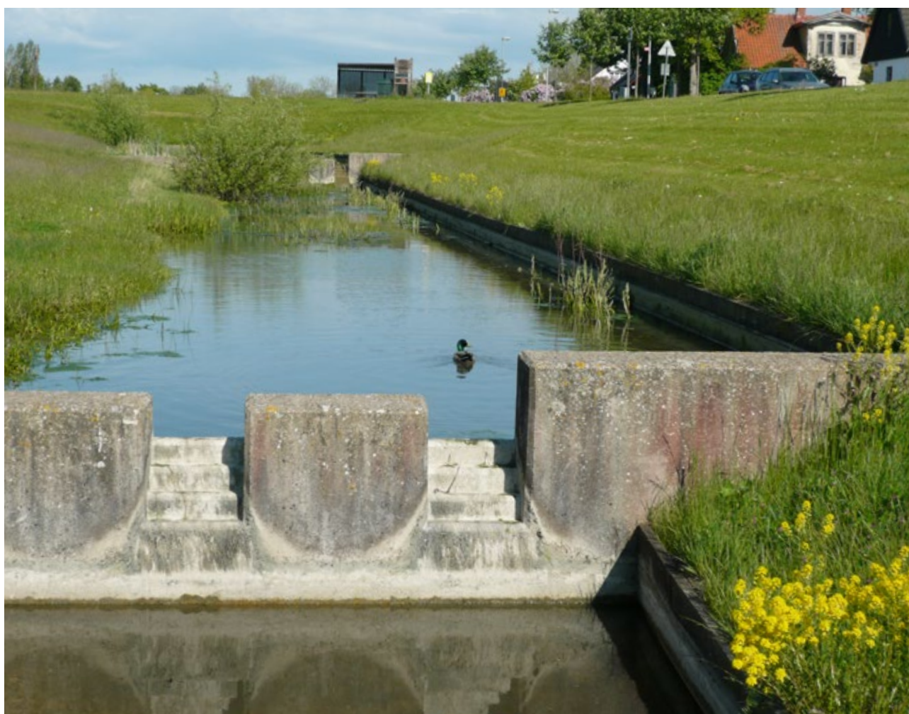
Fördröjningsdamm i form av ett system av dammar i rad som töms efter hand. Normalt finns bara vatten i dammen längst nedströms. Foto: Tilla Larsson.
