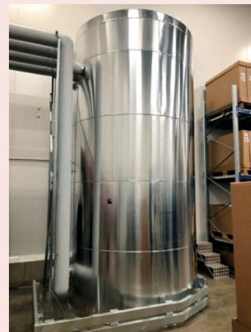
Figur 6 Bild på ackumulatortank.
