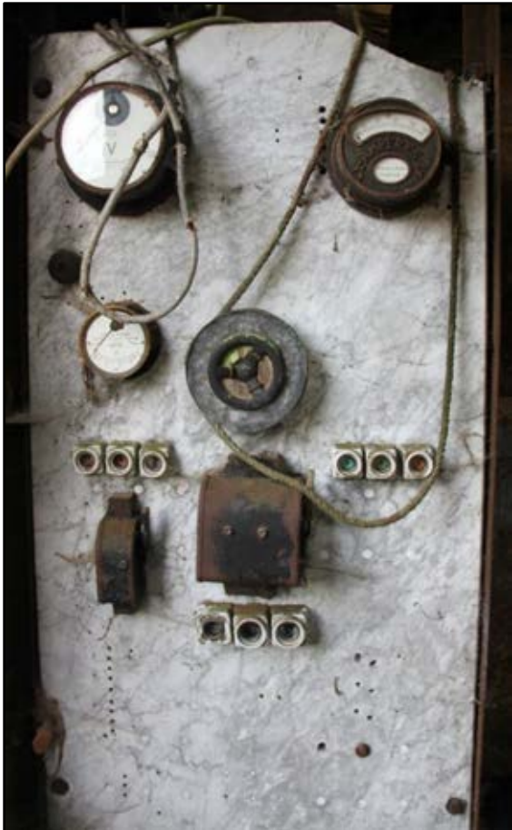
Bild 35 och 36. Precis innanför dörren i maskinboden finns en kontrollpanel av märket Hartmann & Braun, Frankfurt a. M. (1879-) Apparaturen är monterade på en marmorskiva. Foto: Helena Lundgren.
