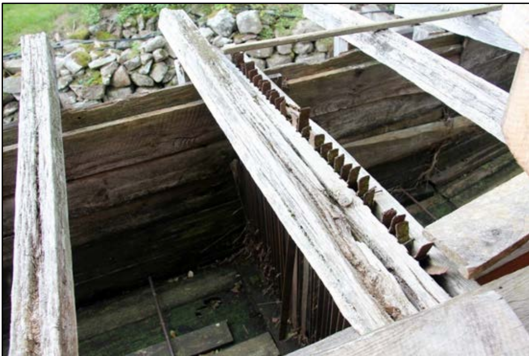
Bild 20. Ett rengaller som förhindrar skräp att komma in i turbinerna finns i trärännan, vilket består av plattjärn som sitter vertikalt intill varandra för att inte hindra vattenflödet. Foto: Helena Lundgren.
