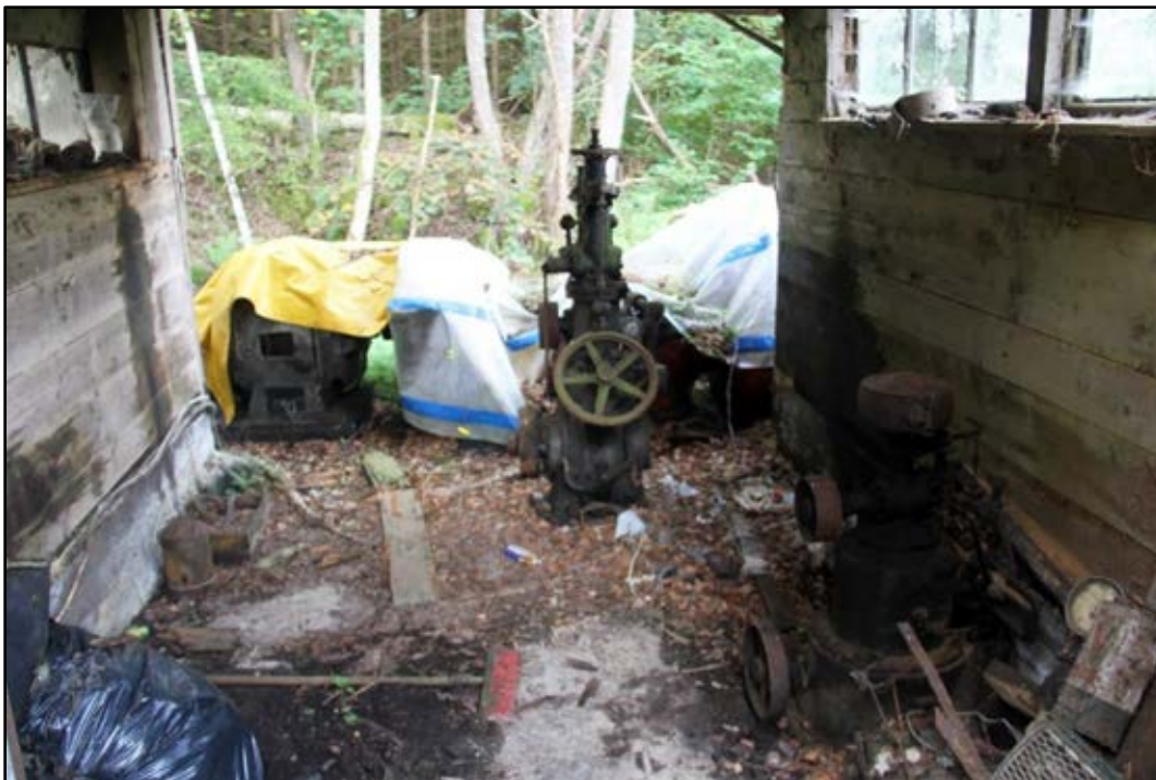
Bild 22. Trots att byggnaden inte är hel finns delar av maskinparken kvar, delvis inne i byggnaden och delvis under bar himmel, eftersom turbinhuset vid ån även saknar tak. Foto: Helena Lundgren.
