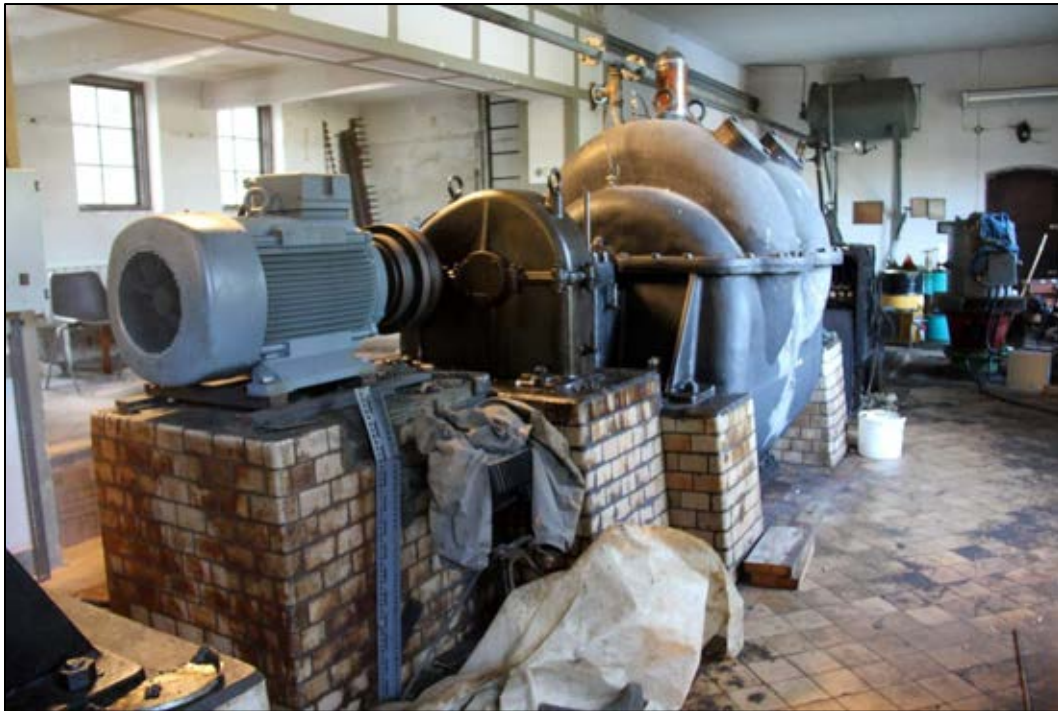
Bild 21. Den mittersta pumpen med en modernare generator. Bilden tagen mot sydost. Foto: Helena Lundgren
