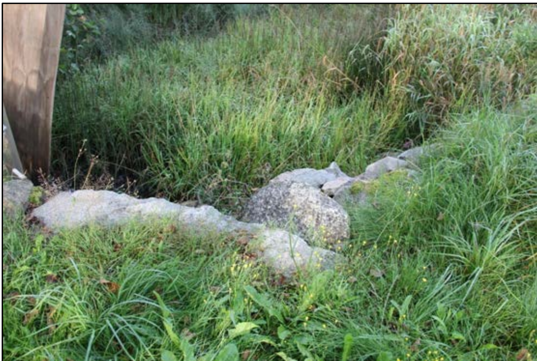
Bild 6. Stenskoning i hörnet mellan bron och dammen. Foto: Helena Lundgren.
