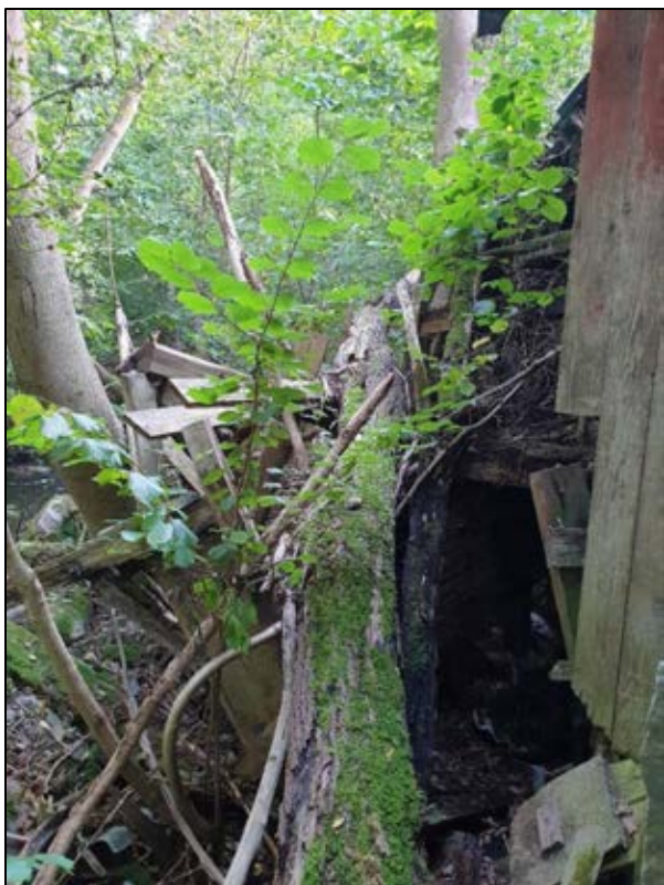
Bild 15. Det raserade turbinhuset och turbinsumpen. Foto: Eva Eliasson
