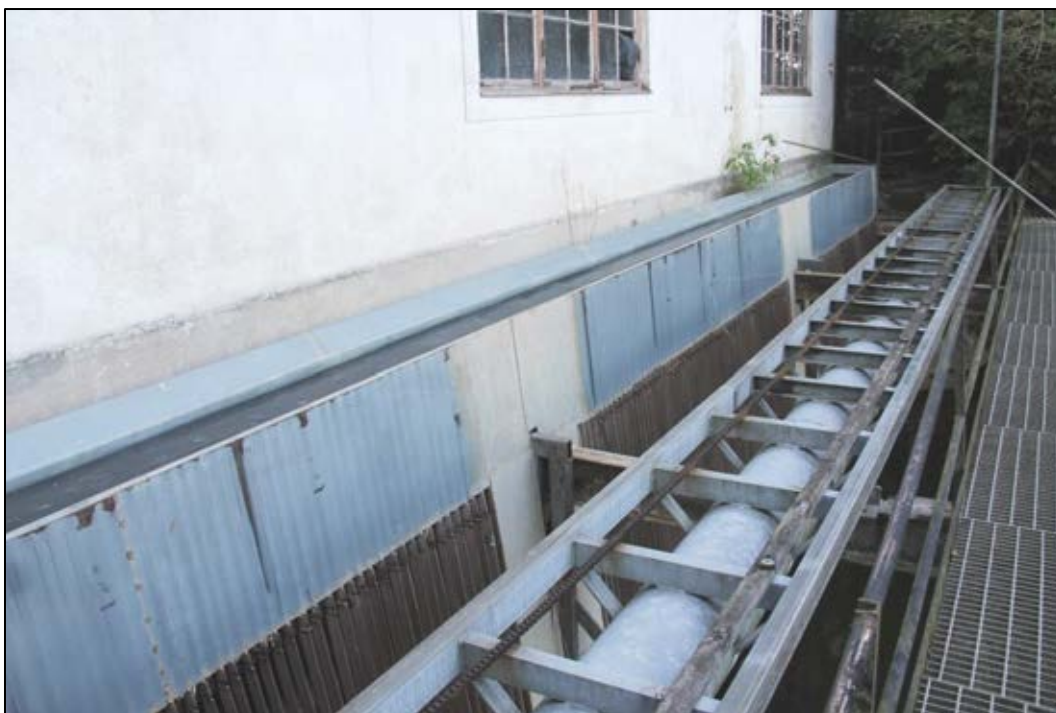
Bild 14. Framför intagen till pumpstationen sitter galler som ska stoppa skräp från att komma in i pumparna. Foto: Helena Lundgren
