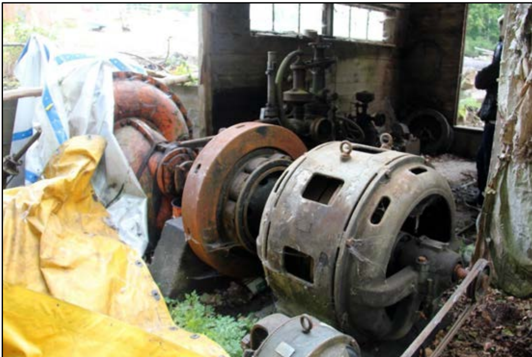
Bild 28. Generator står på en betongklack i f. d. turbinhuset. Foto: Helena Lundgren.
