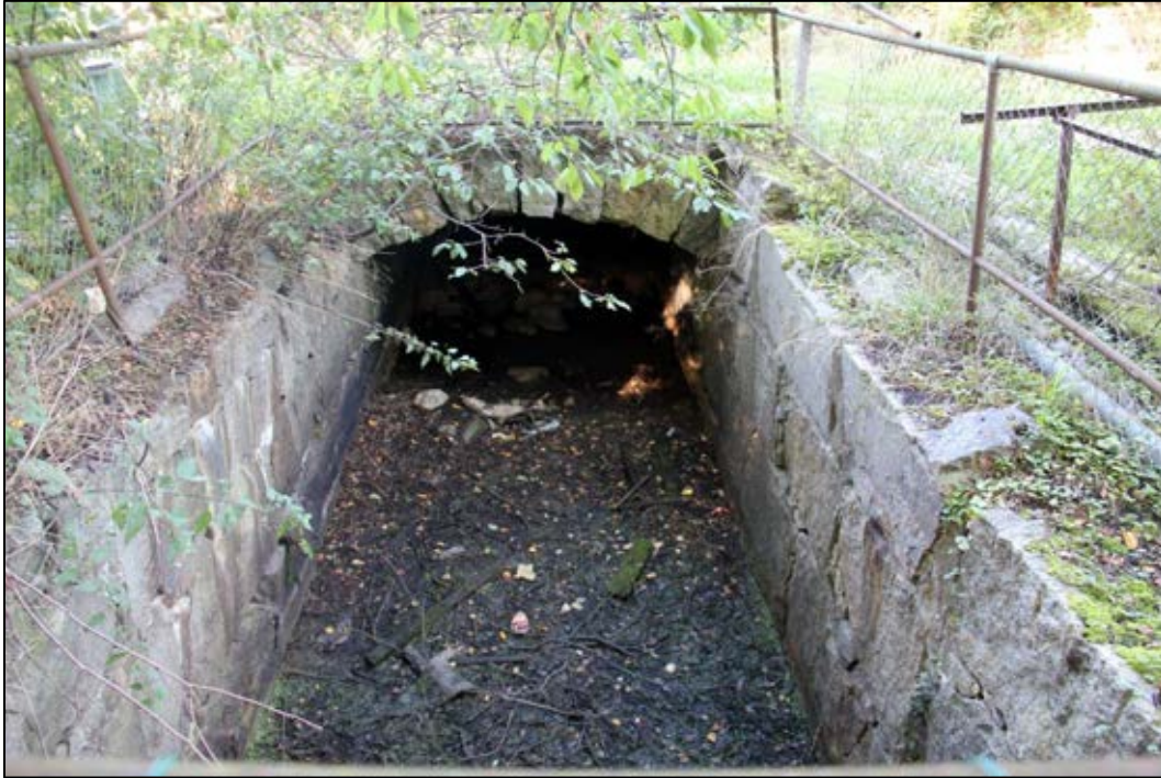
Bild 1. I den här hjulgraven, som ligger norr om den nuvarande pumpstationens byggnad, fanns den första pumpstationens skovelhjul installerat. Bilden tagen mot väster.
