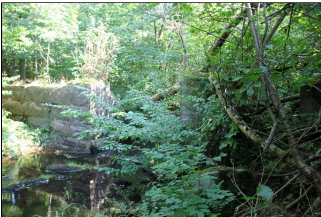
Bild 17. Del av dammkroppen. Mitt i bild syns det utskov där det funnits regleringsluckor, förmodligen spettluckor. Nya luckor sattes dit på 1970-talet men de höll bara ca 10 år. Här syns att det är dåligt med vatten i dammen. Bilden tagen mot sydost. Foto: Eva Eliasson
