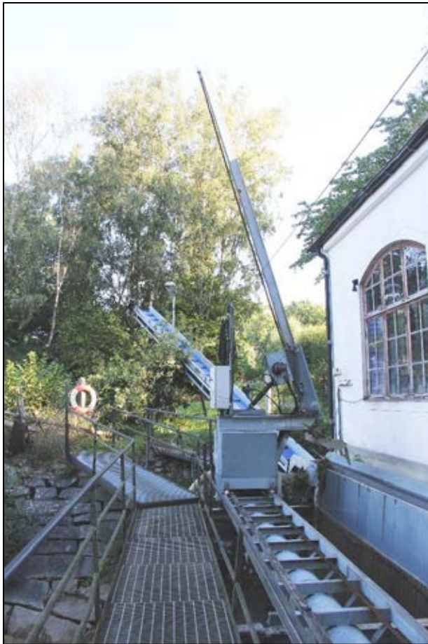
Bild 15. Längs med hela västra sidan av byggnaden finns en bro av gallerdurk. Maskinen med den långa armen används för att samla ihop vass när röjning skett i kanalen. Den kan röra sig fram och tillbaka på skenorna som syns närmast i bild. Bilden tagen mot norr. Foto: Helena Lundgren
