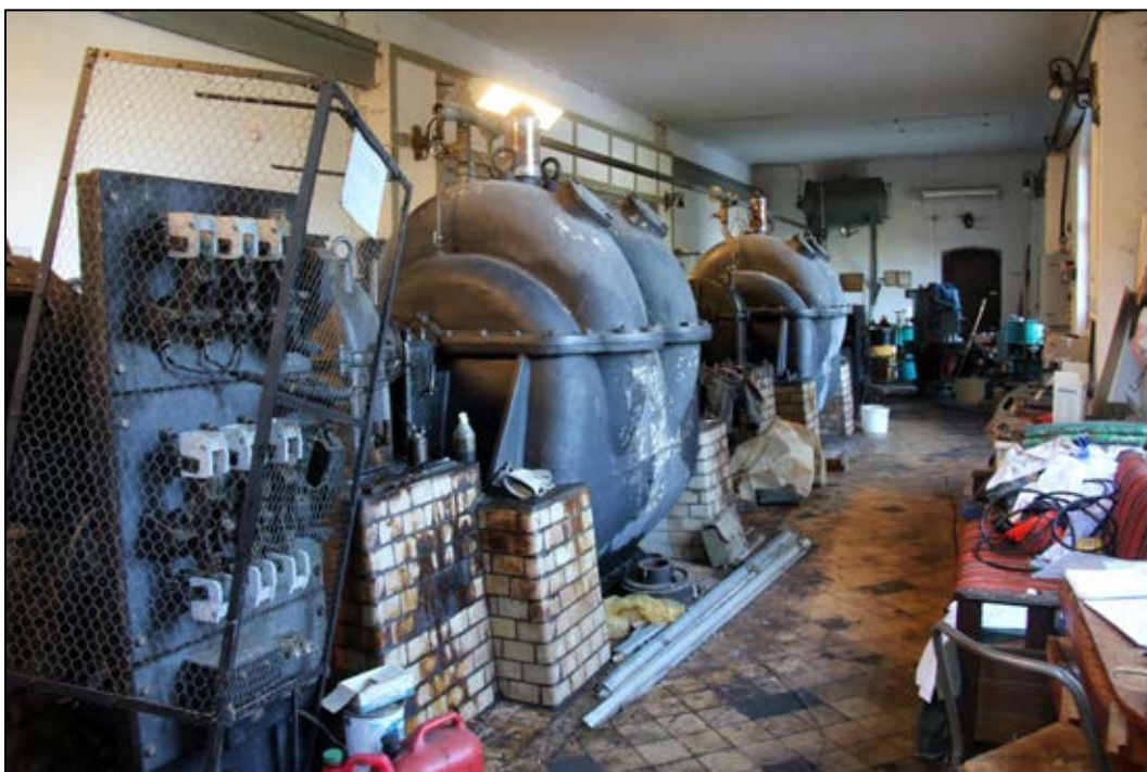
Bild 20. Inne i byggnaden står två stora pumpaggregat med sina generatorer, de är original från 1926. Detta är den norra pumpen, levererad av Aktiebolaget Zander & Ingeström i Stockholm. Bilden tagen mot söder. Foto: Helena Lundgren
