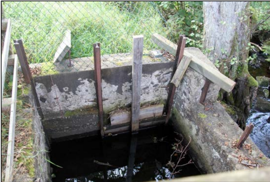
Bild 7. Rest av en turbinsump. Gjutna väggar, nedströms ån intill bron, med trälucka som troligen täcker för stället där turbinaxeln har gått igenom. Foto: Helena Lundgren.
