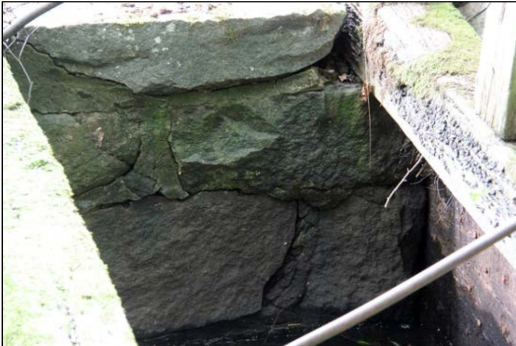
Bild 2. Plankorna i vilplanet mellan bjälkarna har troligen ruttnat bort. På bilden syns huggna stenar som är murade med betong. Foto: Helena Lundgren
