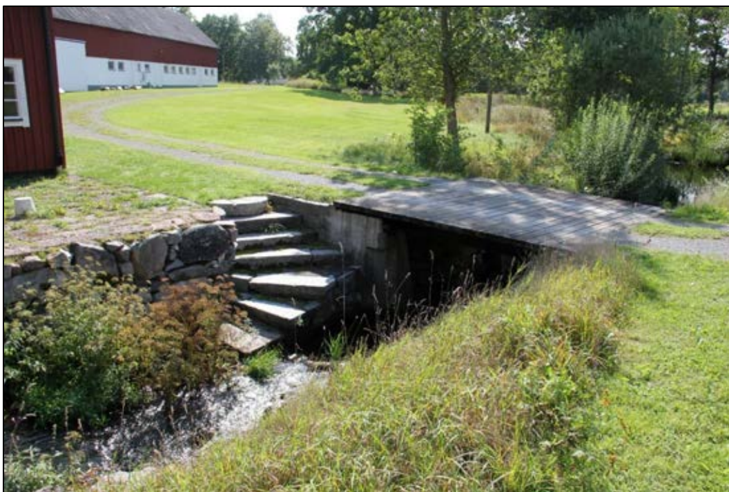
Bild 16. Norr om bron på vattendragets östra sida går en stentrappa ned till vattnet, enligt uppgift använd för tvätt i ån. Foto: Helena Lundgren
