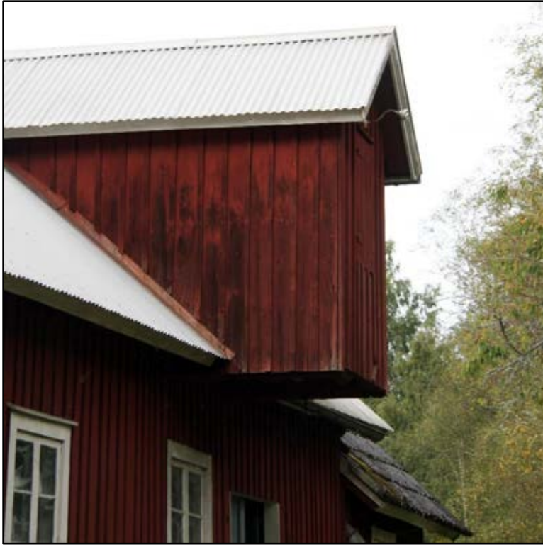
Bild 25. Ovanför lastbryggan finns en utbyggnad med en hissanordning för att få upp sädessäckarna med säd till vindsplanet. Foto: Helena Lundgren.
