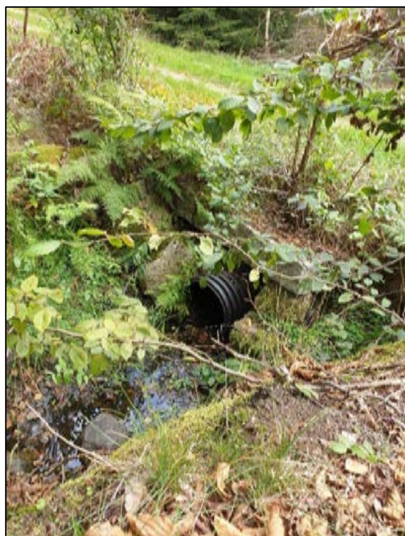
Bild 9. I stenvalvet under vägen finns ett svart plaströr draget som leder vattnet under vägen. Foto: Eva Eliasson
