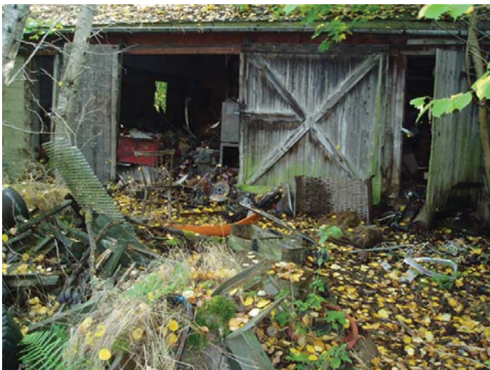
Gamla industribyggnader som inte längre används blir lätt upplag för skrot och avfall Foto: Christer Idström
