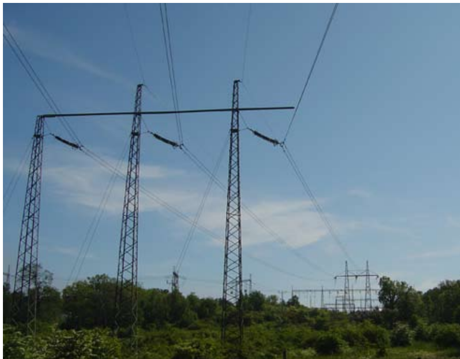
Kraftledningar - en källa till elektromagnetiska fält. Foto: Monika Puch.
