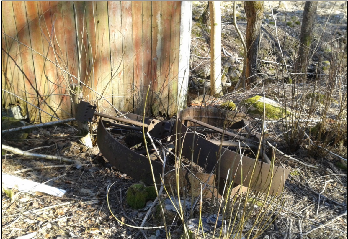
Bild 2. Maskindelar utanför kraftverket. Detta är ett hjul för remdrift. Utrustningen inuti är förstörd eller försvunnen. 2008 när kraftverket besöktes vid den tidigare inventeringen av Mieån, så fanns det mer kvar av den maskinella utrustningen.
