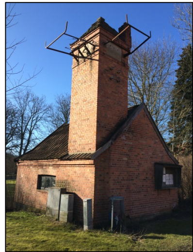
Bild 24. Transformatorstationen vid Jannebergs gård.
