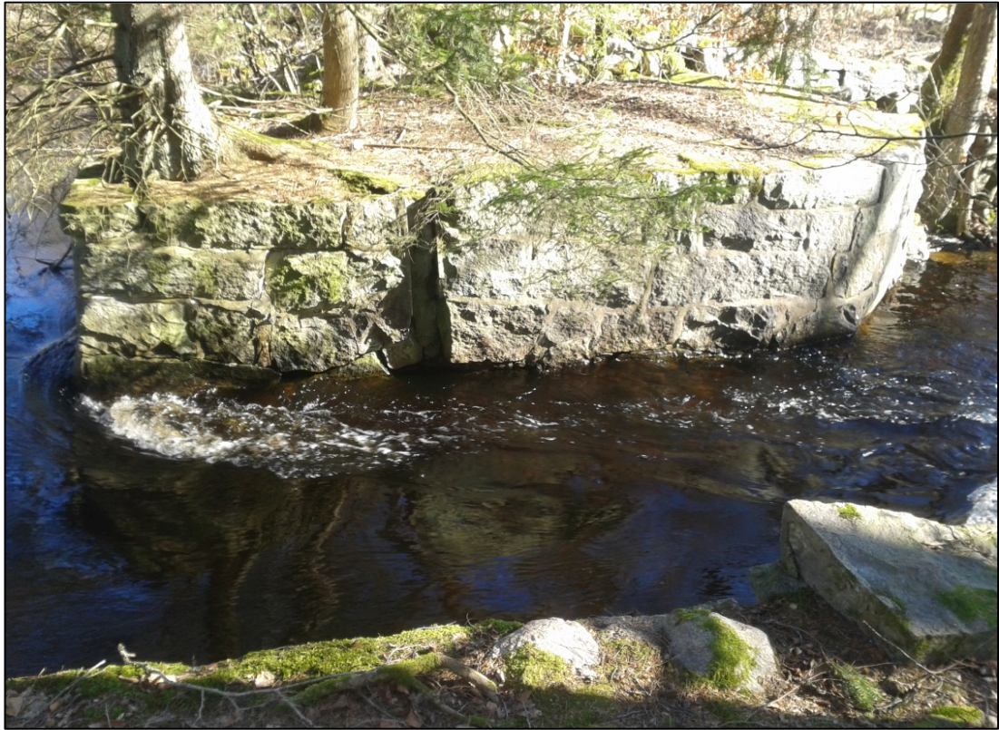
Bild 4. Här har en av dammluckorna suttit fästa
