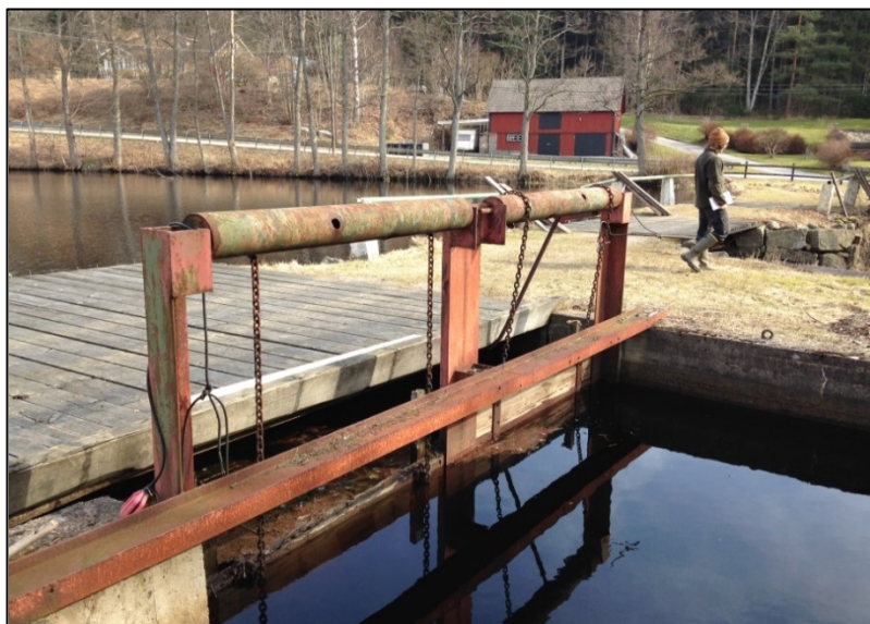
Bild 6. Intaget till turbinen regleras med en spelanordning.
