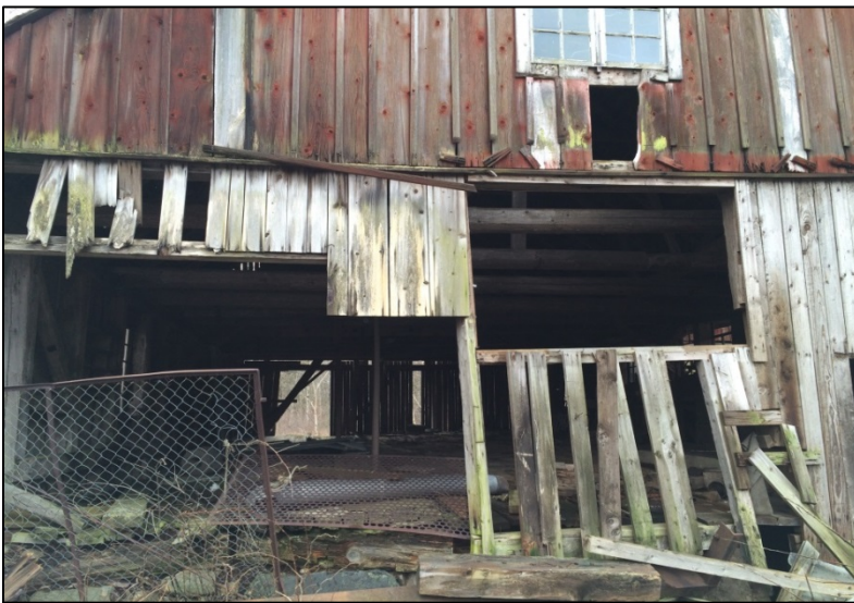
Bild 6. Fasaden mot norr. Byggnaden är i mycket dåligt skick och kommer tids nog att förfalla.
