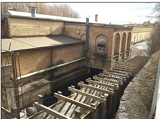
Bild 2. Den äldre delen i Granefors nedre bruksområde. I bild syns även vattenrännan.
