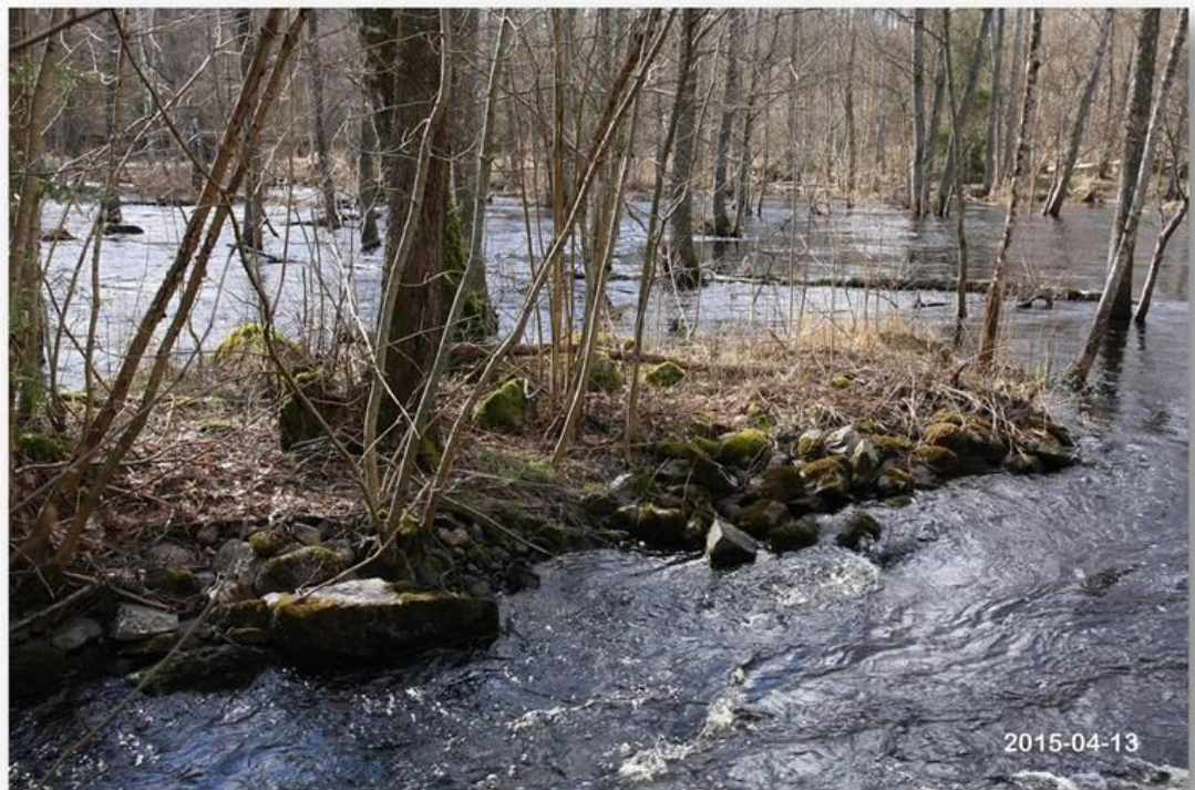
En hög vattenföring innebär stora krafter i omlopp. Ovan är en stensatt flottled med invigningssten från 1733. Några år senare har både minnessten och stora delar av stenskoningen följt med strömmen. Antagligen har något hårdare föremål som exempelvis en stock eller isbildning börjat rubba stenskoningen och sedan har processen gått snabbt. Foto: Rudmar Qvist.
