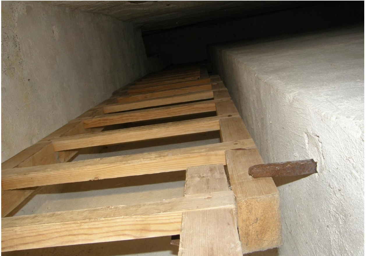
Fig. 13. Trästege i nisch, se planritningarna. Stegen leder till utrymmet mellan de bägge valven.
