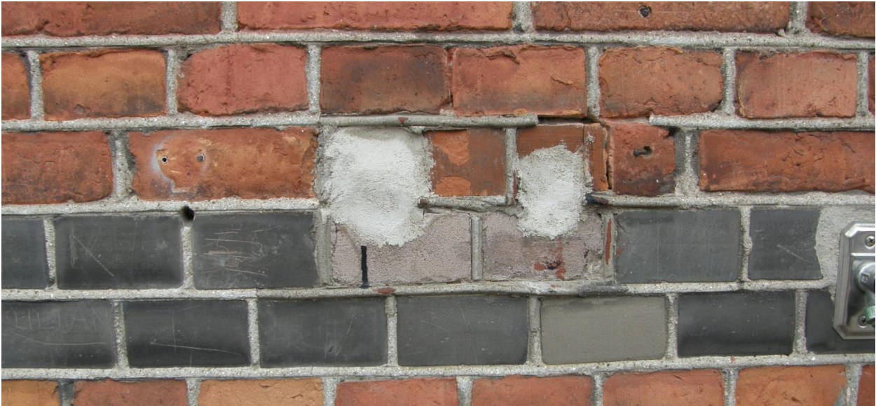
Fig. 19. Slarvigt utförd tegellagning på västra fasaden.
