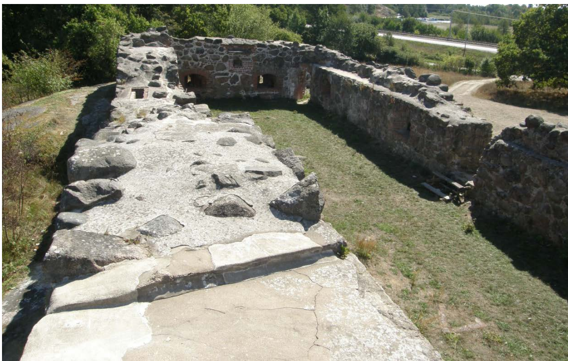
Fig. 23. Vy från murkrönet, mot söder. Trätrappan till höger i bild. I förgrunden sprickor i murkrönstäckningen.
