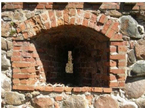
Fig. 13. Frostsprängt tegel i fönsteromfattning.
