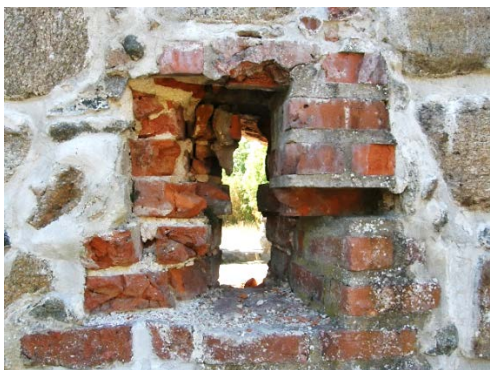
Fig. 8. Frostsprängt tegel i fönsternisch.
