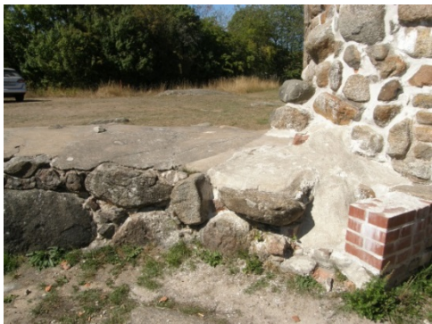
Fig. 14. Södra tornet, bortfallen fog.
