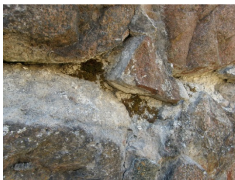
Fig. 13. Exempel på spjälkade fogar.
