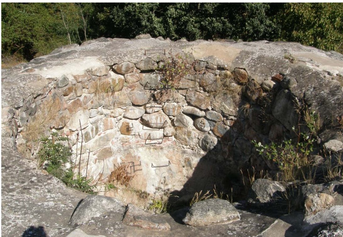
Fig. 20. Norra tornets insida. Inmurade järnsteg vars status bedöms som osäker.
