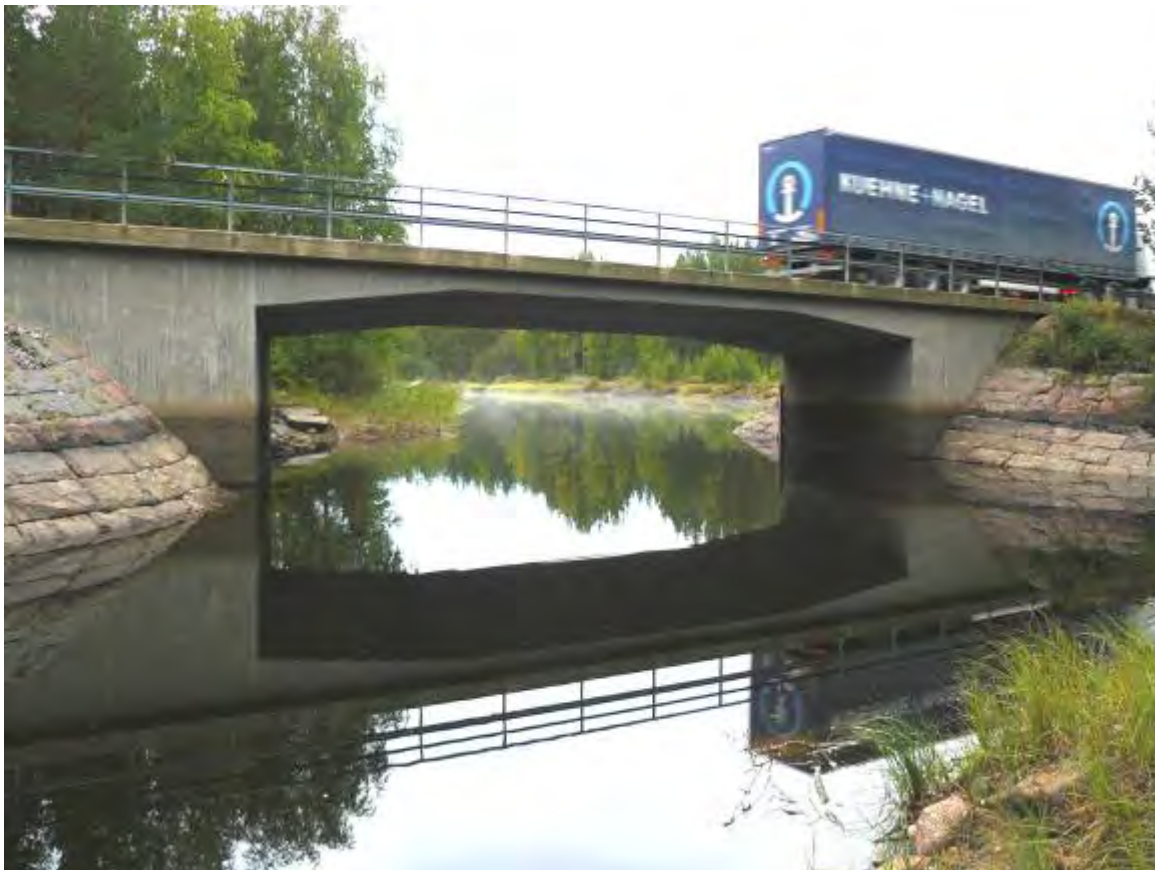
Foto 6. Bro i behov av spång. Bro 6846775-1469213, Los väg 310. Foto: Länsstyrelsen Gävleborg
