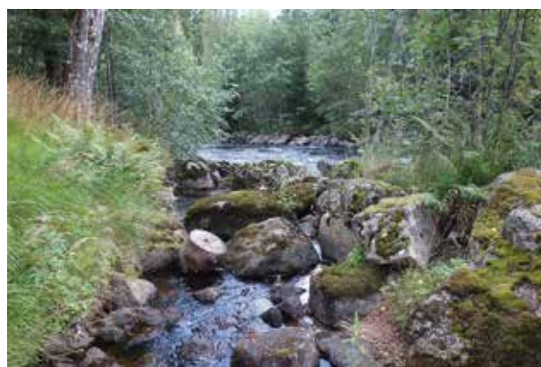
Fig. 46. Vattenledare (18) med igensatt ände.
