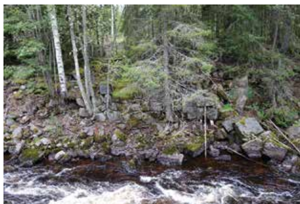
Fig. 16. Damm (1) på åns norra sida, delvis nedrasad i ån. Huggna stenar, kallmurad i skalmur och i botten en trästomme. Några stenar har urhuggna hål och järnband.
