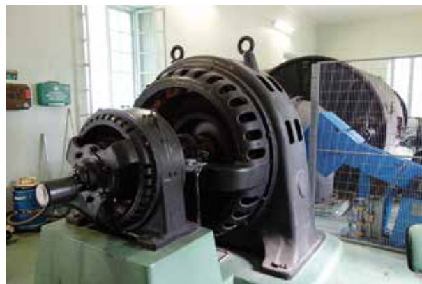
Fig. 96. Generator inne i kraftstationen.
