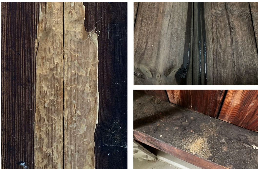
Bilden till vänster. Kraftigt angrepp av vedätande insekt, stående plank vid entré. Bilden upp till höger. Rinnande vatten på insidan av ytterväggens plankbeklädning. Bilden nere till höger. Angrepp vedätande insekt på tvärbalk av trä.
