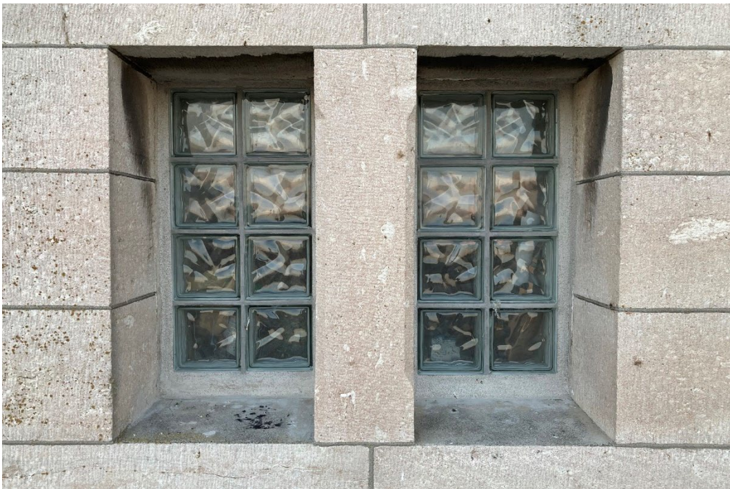
Betongglas har ersatt de ursprungliga öppningsbara fönsterbågarna i både markplanet och fyrornets trapphus. Parti fasaden mot öster, söder om entrén.
