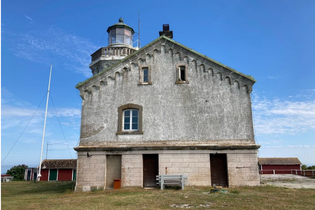
Fasad mot söder. Putsen missfärgad av alger och rinningar från svalbon under taklisten av betong.
