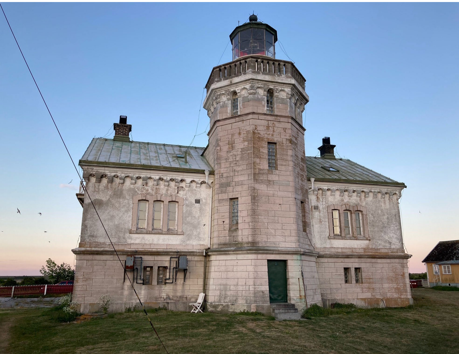
Fyren västra fasad. Puts och kalksten är missfärgade av alger, färgbortfall och rinningar av fågelavföring (från svalbon).
