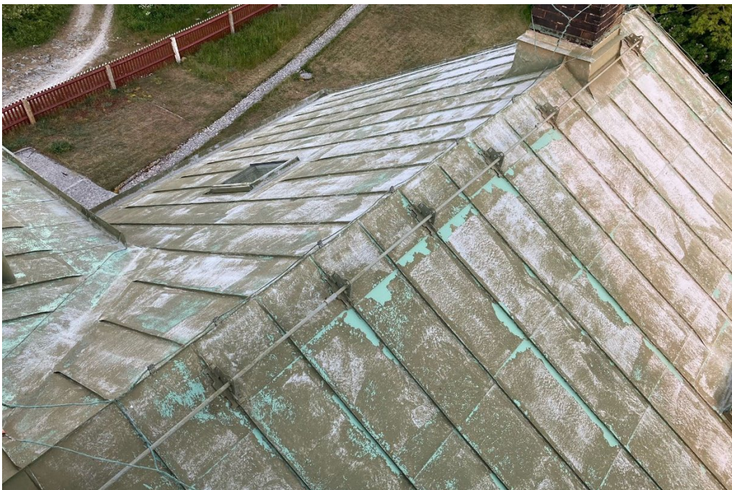
Takplåten har förlorat det mesta av både grundfärg och täckfärg. Takfönster från 60-talet där produktlivscykeln gått ut.
