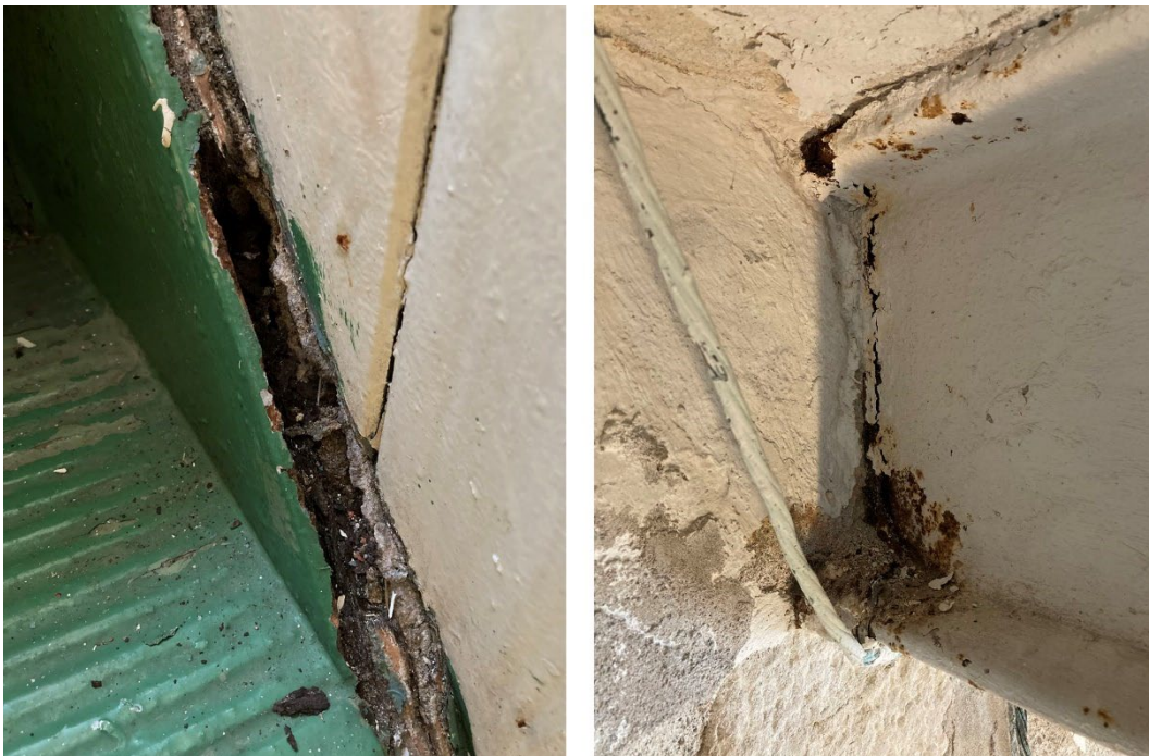
Bilden till höger. Trappan av gjutjärn till den yttre plattformen under lanterninen. Bilden till höger. Inmurad järnbalk under bjälklaget till vaktrummet. Det är viktigt att murverket håller en godtagbar fukthalt som fördröjer korrosionen av byggnadsdetaljer av järn. Dessa är ofta ingjutna eller inmurade och svåra därmed att ersätta.
