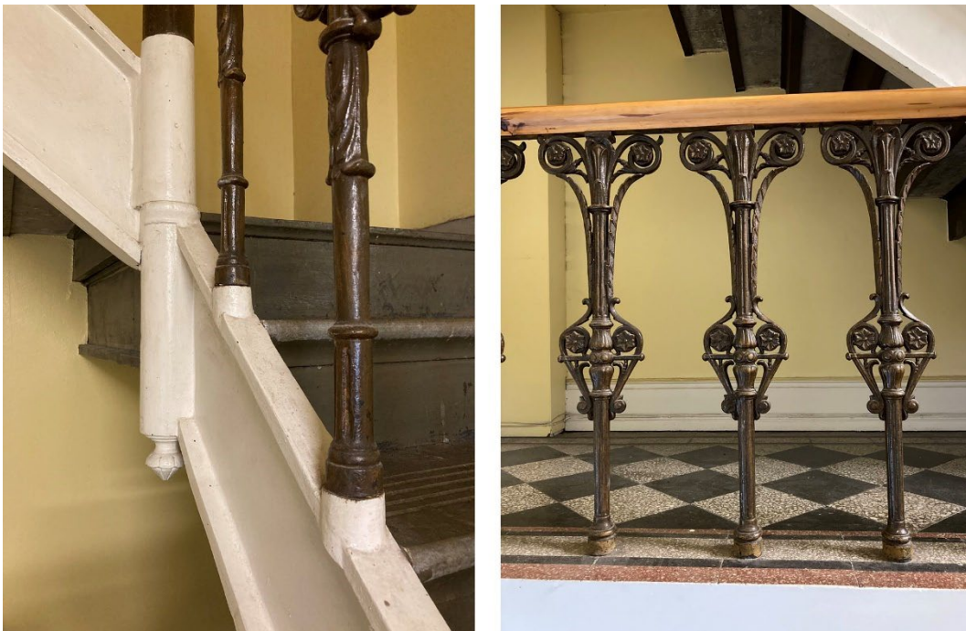
Bild till höger. Vangstycke och räckesstolpar av gjutjärn trappan till andra våningen. Bild till höger. Räckesstolpar av gjutjärn med överliggare av profilfräst trä. Trappterrassen första våningen (201).
