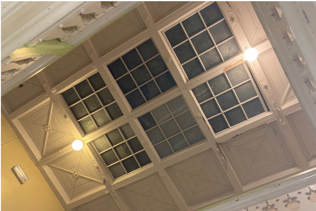
Nuvarande utförande där glaset vid inspektionen var helt av isolering.
