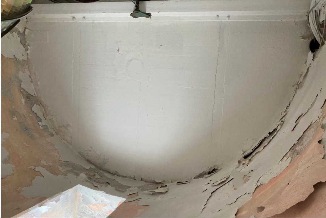
Bjälklaget till vaktrummet som fyrapparaten vilade på. I centrum spår efter lodets hål. Två kraftiga ingjutna järnbalkar bär upp betongvalvet.
