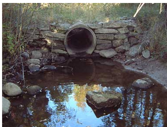
Bild 7. Underdimensionerad och felplacerad vägtrumma. Trumman bör sänkas under åns bottennivå. (vattensträcka A3)
