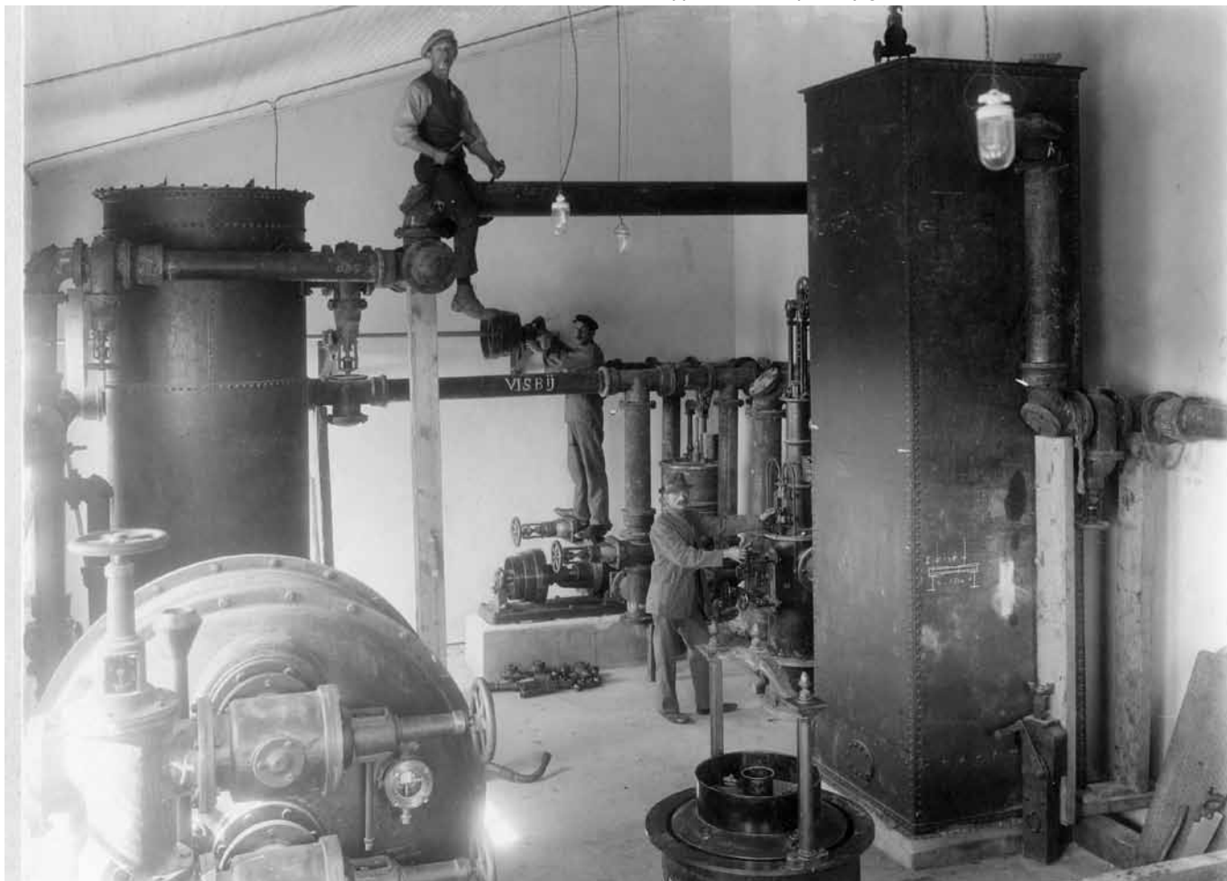
Bild från apparatrummet på Visby gasverk, 1910-tal. Foto: Mats Falcks bildarkiv.
