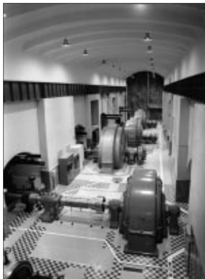
Maskinhallen i Porjus gamla kraftstation, Jokkmokks kn (1993).
