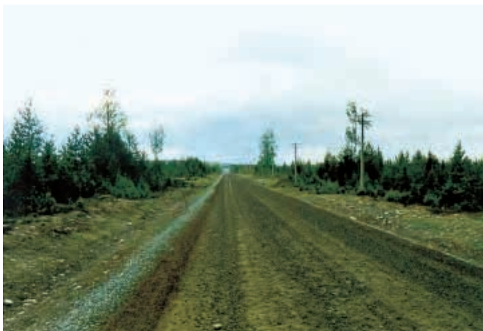
Väg 1013 löper i långa sträckor, spikerakt genom landskapet, ett karaktäristiskt drag för vägar anlagda på 1930-talet.
