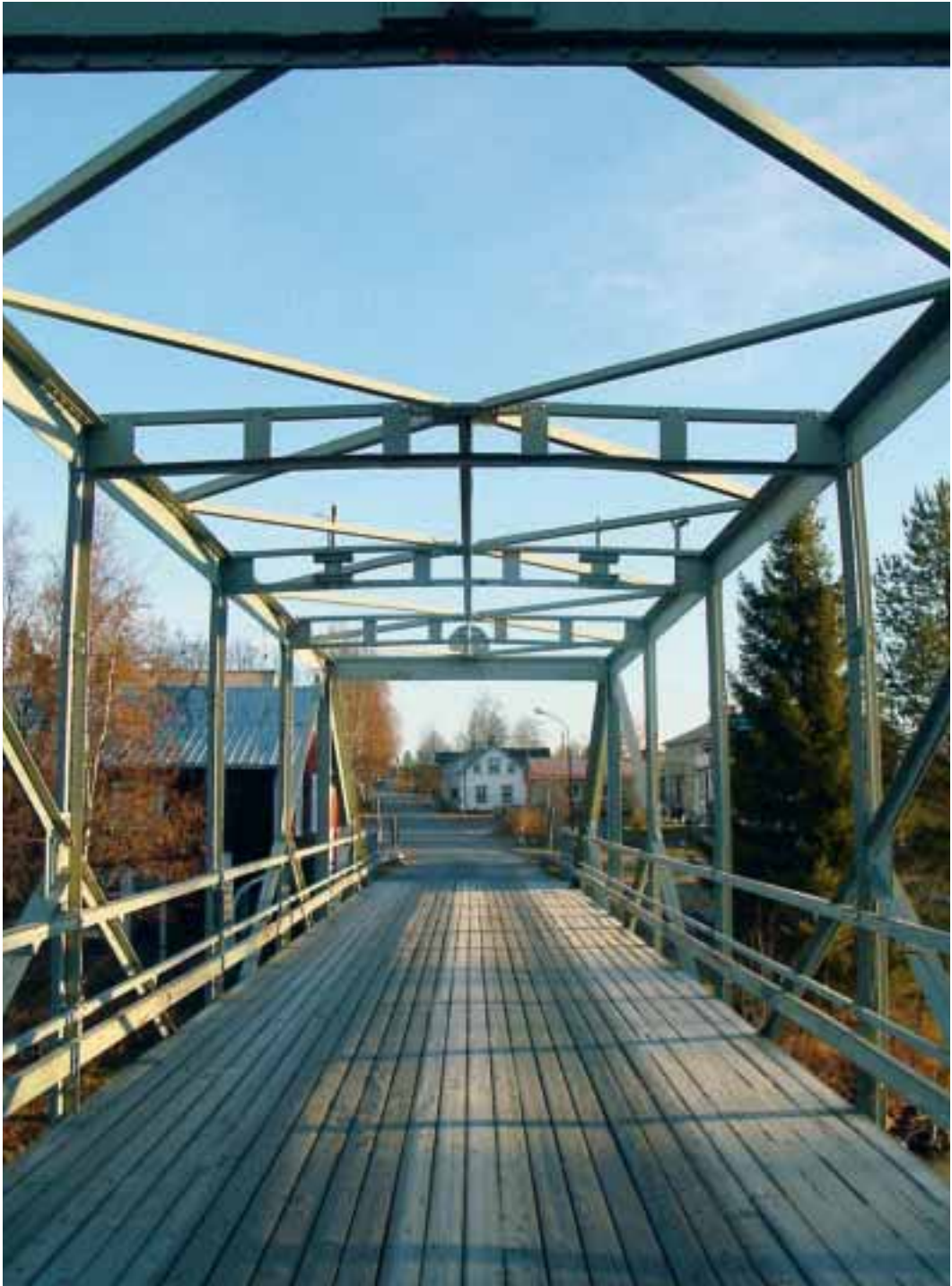
Sundbron i Rognäs-Sjulnäs byggdes 1921-22 av Norrlands statsarbeten som ett AK-arbete. Brons överbyggnad av trapetsfackverk tillverkades av Bergsunds Mekaniska Verkstad i Stockholm. Den är en av de få bevarade fackverksbroarna för vägtrafik i länet.
