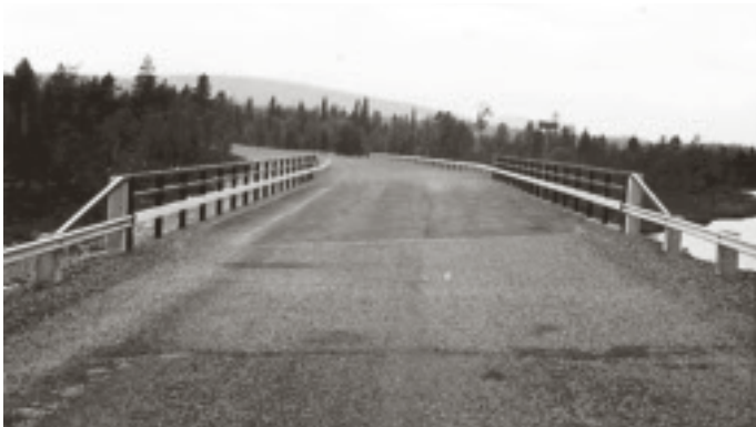
Vägräcket av träplank har ersatts av vitmålad kohlswabalk på betongståndare. De höga betongståndarna är fortfarande i bruk. BD 1229, balkrambro över Grundsälån på väg 94 nordväst om Åkroken, byggd 1959. Foto 1962, Vägverket Region Norr.
