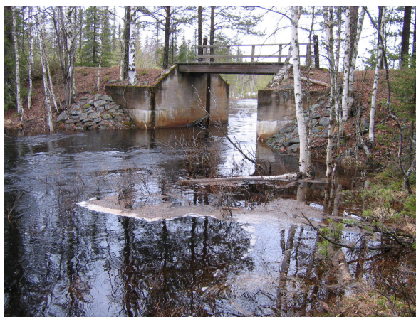
Dokkasbergsdammen är ovanlig med utskoven i helgjuten betong och reglering med hjälp av en vinsch.
