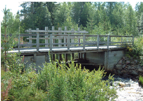
Ohtanajokidammen, ett fint exempel på flottningsdamm.
