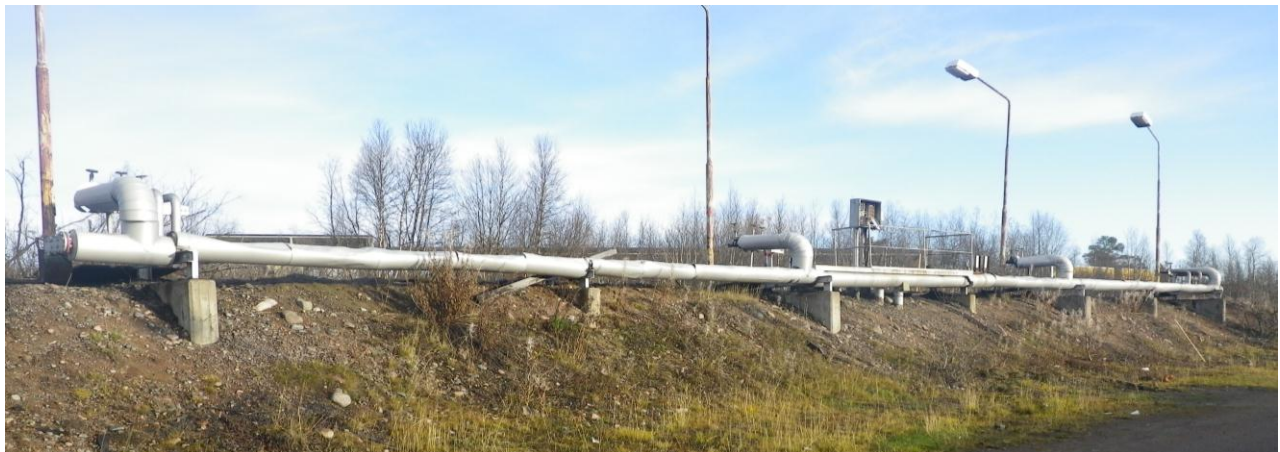
Stickspåret i Kiruna har underjordiska ledningar till angränsande fastigheter i vilka petroleumprodukter har transporterats och misstänks ha förorenat delar av industriområdet (Foto från platsbesöket 2011).
