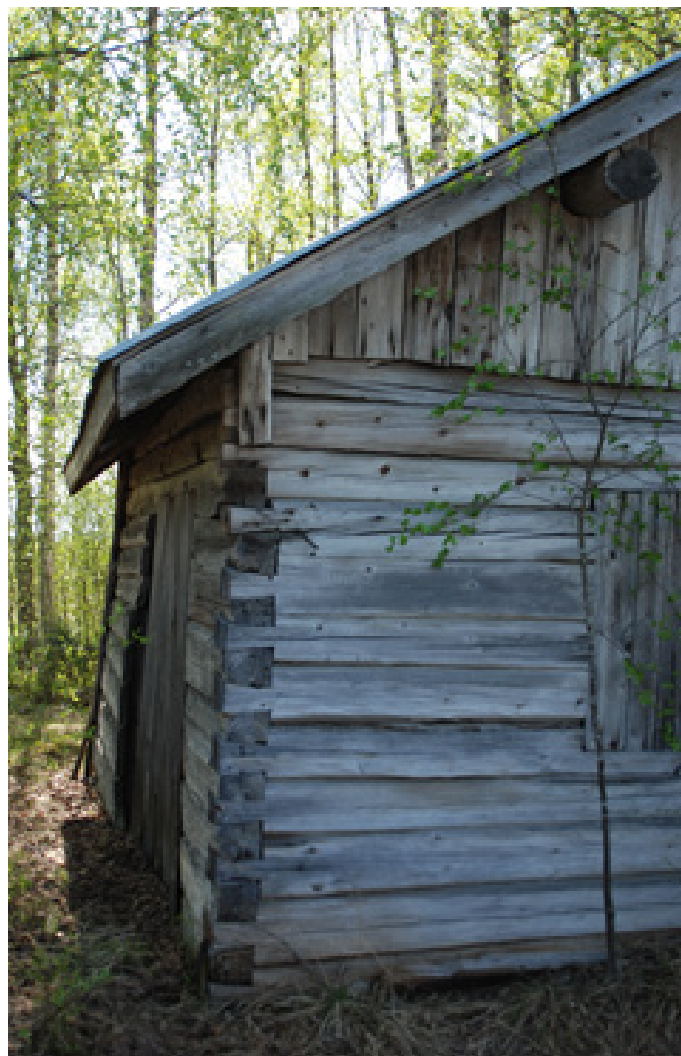
Figur 22: Byggnad med jordnära timmerkonstruktion. Ökad jordmänsbildning kan leda till ökade risker för röta, skadeinsekter m.m. Bild: WSP.
