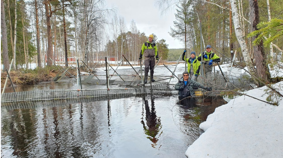
Figur 49. Installation av fiskräknaren i Linabäcken 2021. Foto Länsstyrelsen i Norrbotten.
