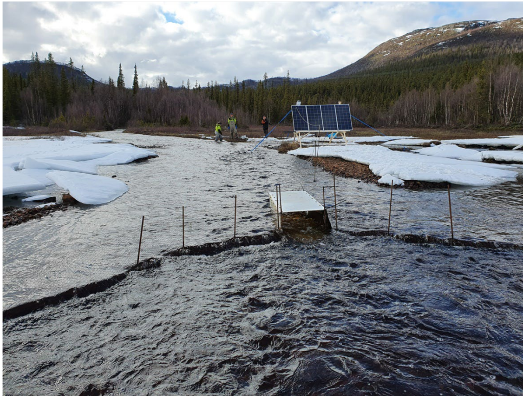
Figur 33. Installerad fiskräknare Simsonar FC med instyrningsgaller för uppvandrande fisk i Tsåkesjokk och solpaneler för uppladdning av batterier den 26 maj 2021. Foto: Länsstyrelsen i Norrbotten.
