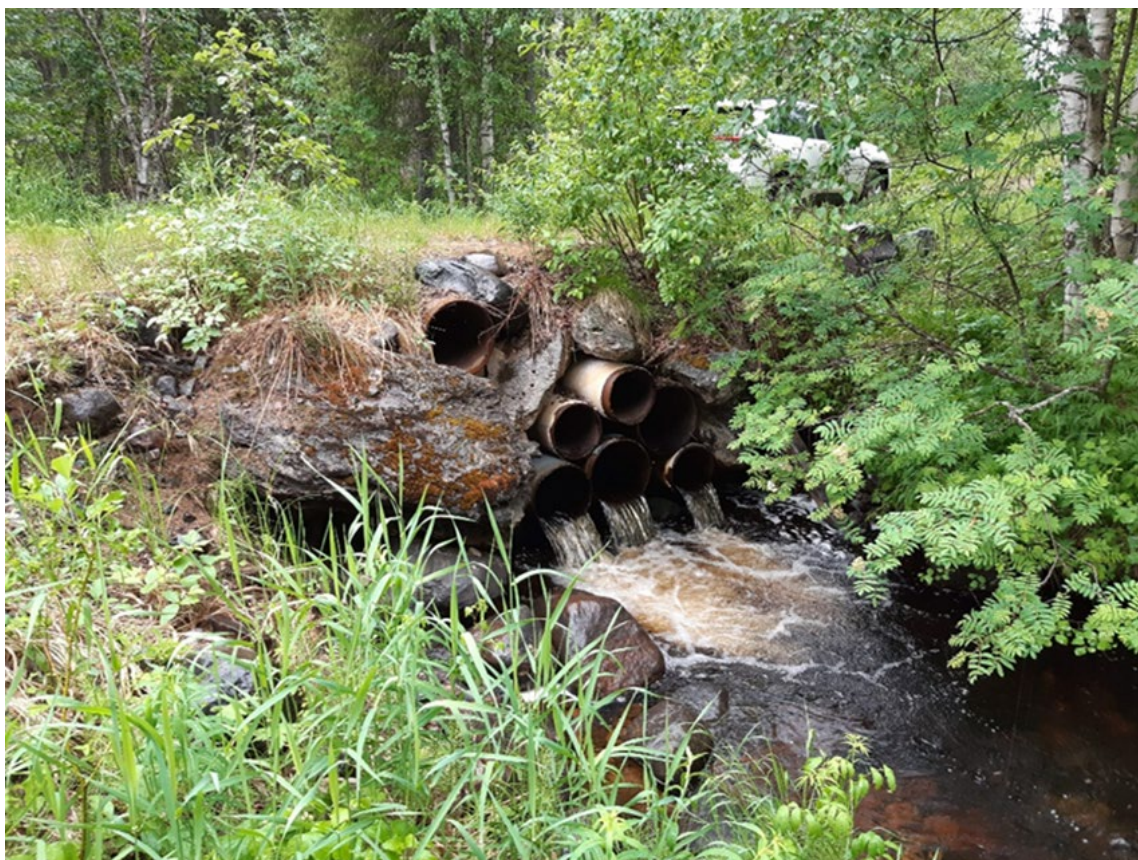
Figur 63. I Sihtunajoki fanns 7 mindre vägtrummor innan åtgärden utfördes. Foto: Timo Lettijeff, Lapplands NTM-central.
