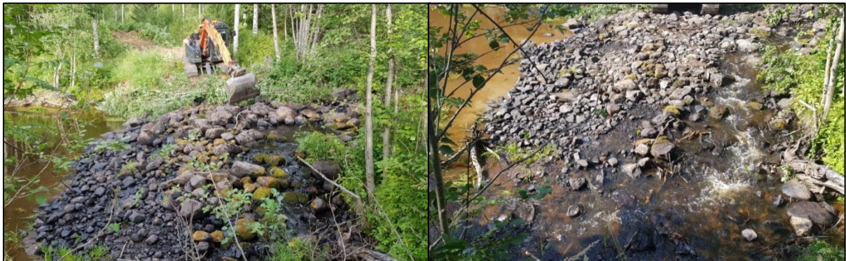
Kuva 4.9. Vasemmanpuolinen kuva esittää patoporrasta ennen toimenpiteitä ja oikeanpuoleinen muodostettua virtausuraa kiviportaiden alimmassa osassa. Muokkauspäivänä veden virtaus oli noin 5 l/s.
