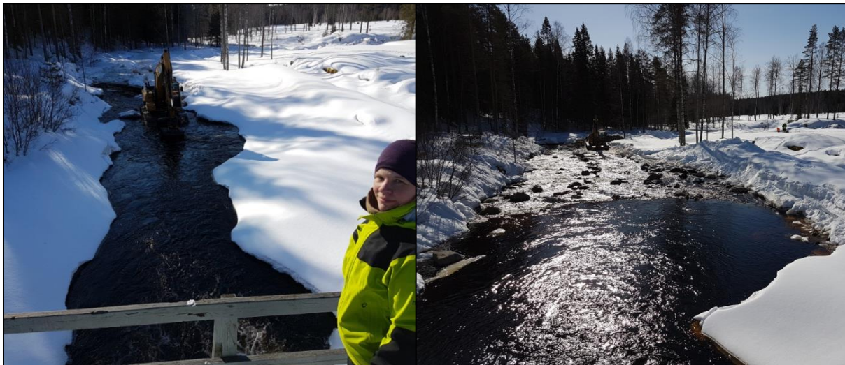
Kuva 4.23. Vasemmanpuoleisessa kuvassa materiaalia siirretään kaivinkoneella Alånin pääuomassa ylävirtaan, ja oikeanpuoleisessa kuvassa näkyy kivimateriaalin asettelu toimenpidealueelle.
