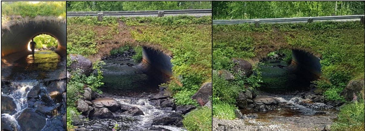
Kuva 4.14. Rosfors, tierumpu Rosånissa. Kaksi vasemmanpuoleista kuvaa on tilanteesta ennen toimenpiteitä, ja oikeanpuoleisin muokkauksen jälkeen.
