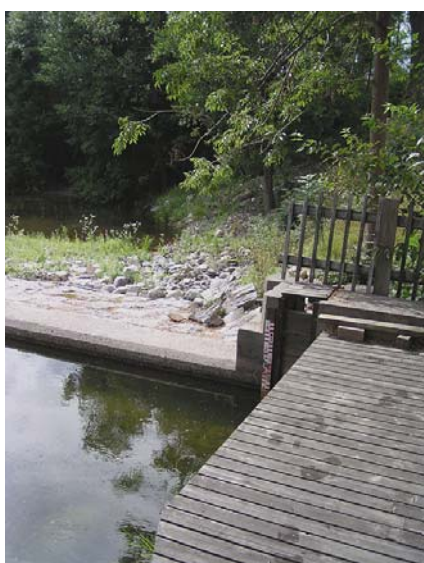
Figur. 30. Befintlig pegel och regleringslucka (stängd vid inventeringstillfället) i den nordvästra delen av dammvallen mot Båven. Foto: Jakob Bergengren, 17 aug. 2004.
