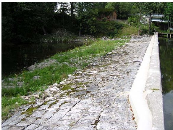
Figur. 29. Den nya dammvallen mot Båven, efter att reparation genomförts under hösten 2003. Foto: Jakob Bergengren, 17 aug. 2004.
