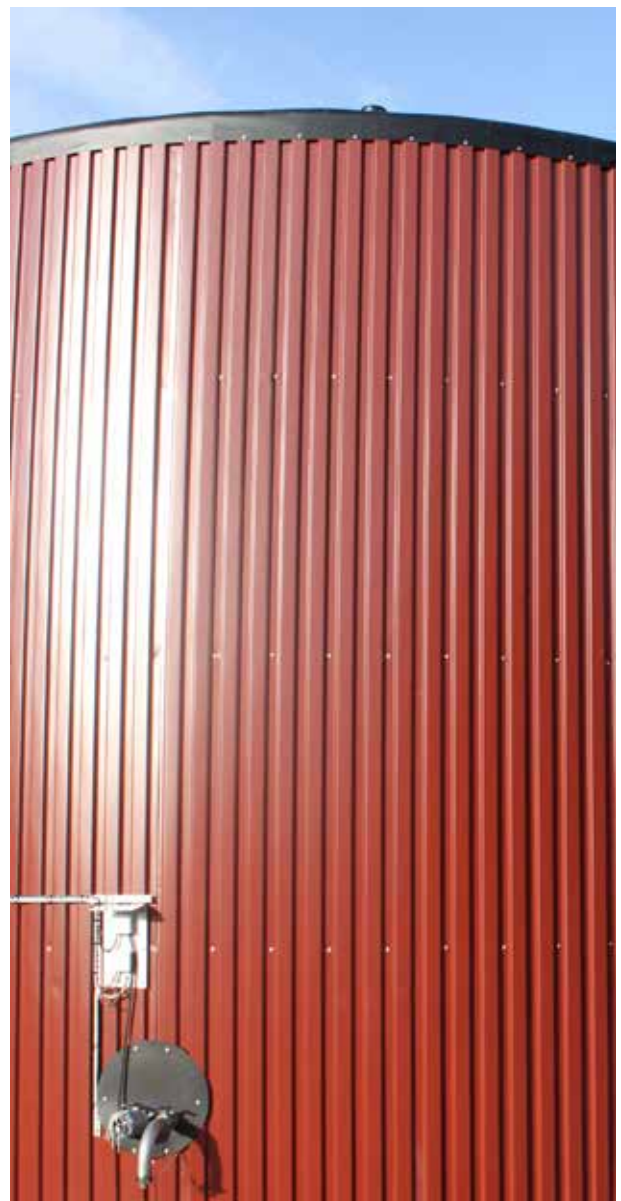
Vid biogasanläggningen i Katrineholm produceras årligen cirka 3 miljoner kubikmeter biogas från i huvudsak gödsel från närliggande lantbruk.
