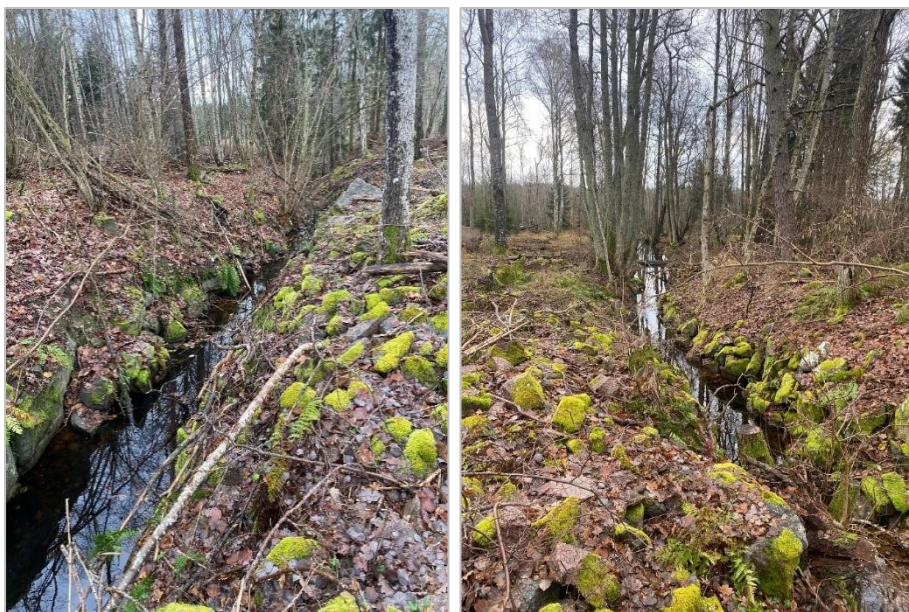
Figur 24. Sprängt dike vid utloppet av Kvarnsjön. Structor, 2021-11-11.
