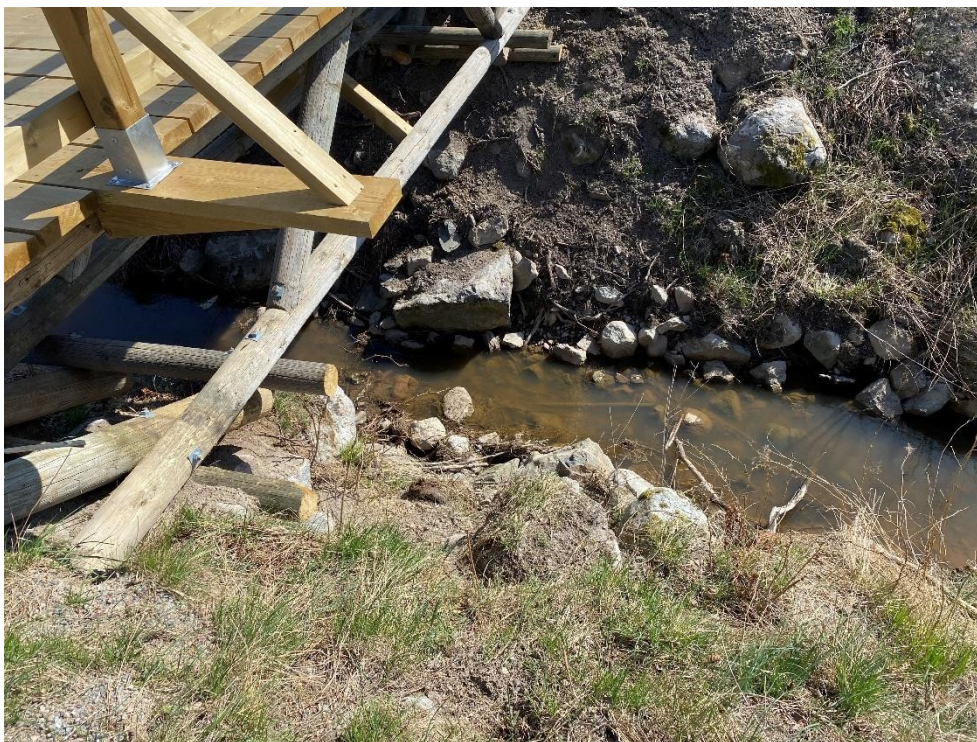
Figur 23. Möjlig leklokal för id under träbron vid Tegelkällan.
