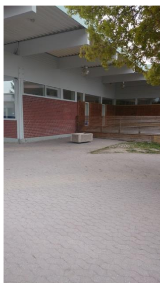
Askkopp placerad under väderskyddande byggnad
