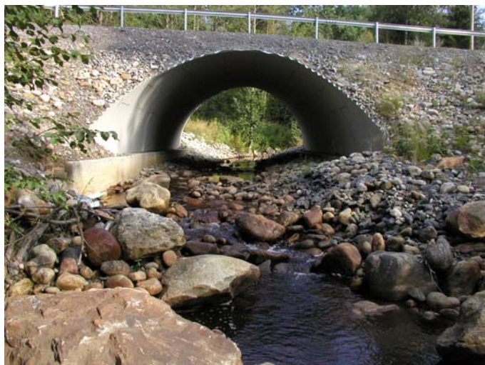
Figur 34. Valvbåge av plåt. Fundamenten var ursprungligen överfyllda med sten. Erosion har delvis frilagt det vänstra fundamentet.
