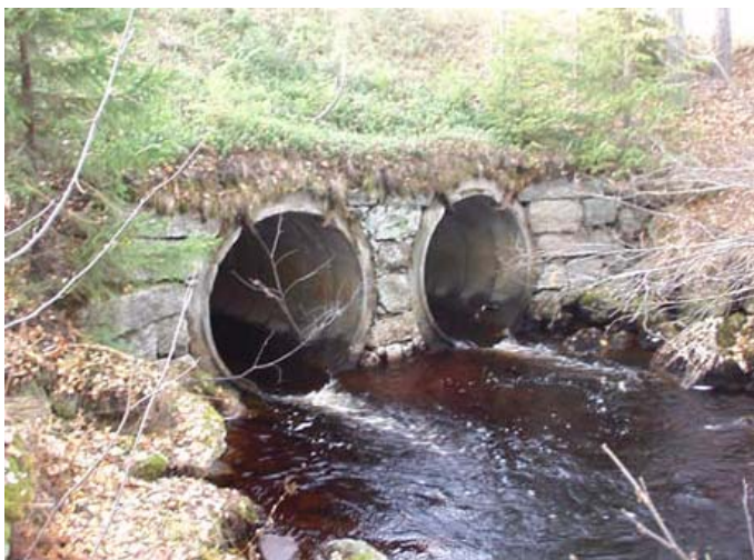
Dubbla vägtrummor av betong i Malbäckens mynning. Trummorna utgjorde vandringshinder av måttlig karaktär.
