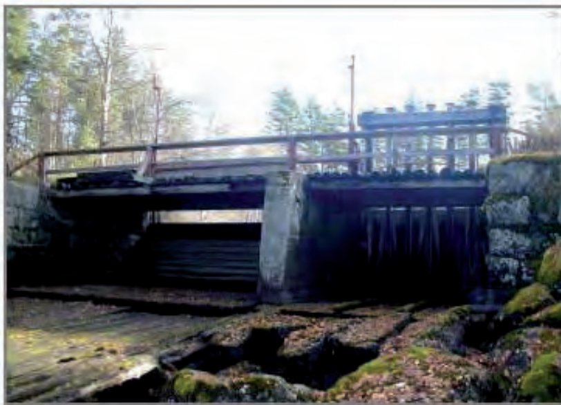
BILD 3. Norstdammen, Åman, bivattendrag till Vindelälven. Kombinerad flottnings- och kraftverksdamm (ID-nr 532, BILAGA 1). Det är ett bra exempel på en dammanläggning med två utskov, där den ena har bjälksättar som dämme (vänster) och den andra luckor (höger). Utskovet består i huvudsak av kilad sten (mellanväggen i detta fall av heljuten betong).
