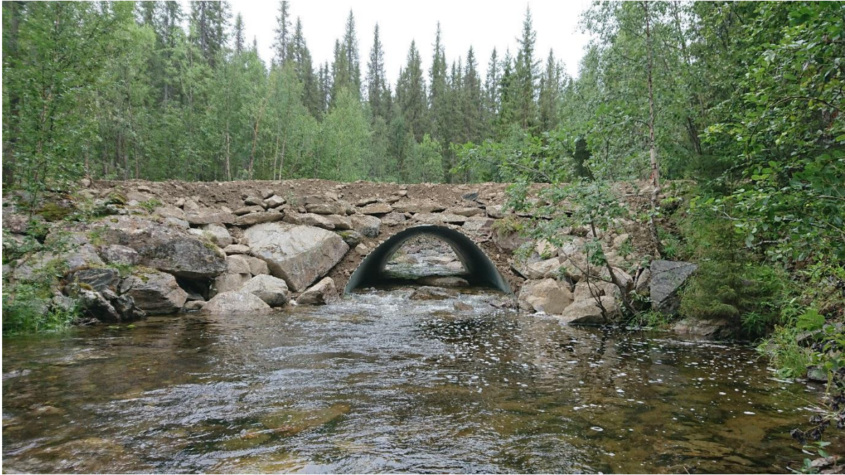
Bild på den nylagda vägtrumman i Gäddbäcken som nu möjliggör fri vandring för öringen i bäcken.
