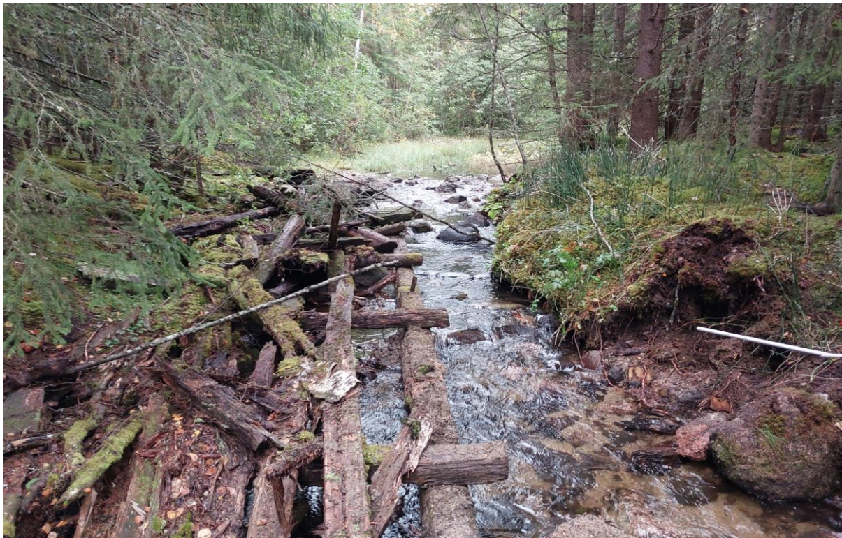
Figur 64. Efter restaurering, östra delen av dammen är bortrivet och stenar utflyttade i vattnet för att skapa en mer funktionell och varierad strömsträcka, Holmsjöbäcken 2023.
