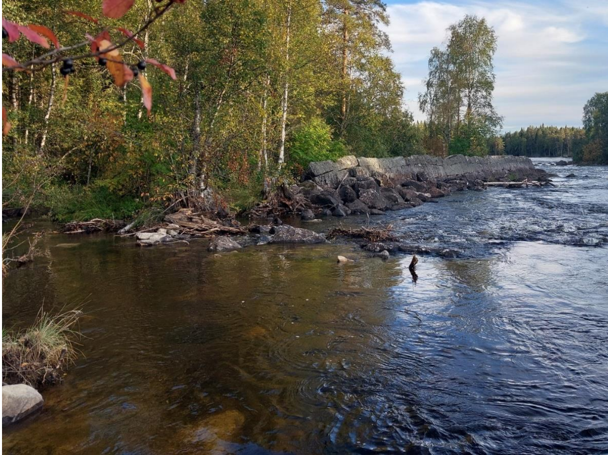
Figur 40. Öppning uppströms muren åtgärdssträcka 6 (SWEREF N 7035742, Ö 523214). Själva muren har inte blivit påverkad men en del av blocken i rensvallen framför muren är utplockade och använda i forspartiet som syns till höger i bild, Ammerån 2023.
