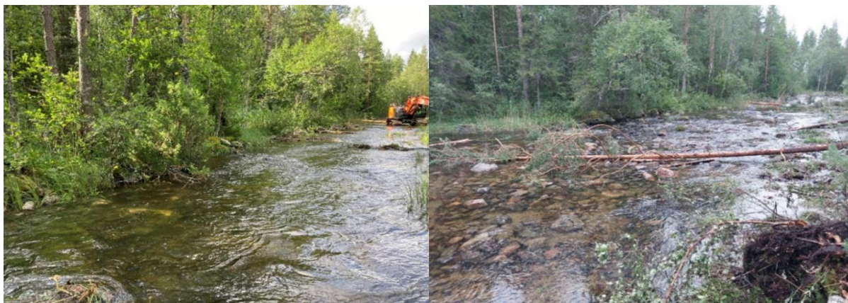
Figur 69. Norån 2023, sträcka 1, uppströmsvy. Till vänster i bild före restaurering, en avstängd ytterkurva. Rensmassorna är använda till att bygga upp botten, bromsa upp vattnet och styra in vatten i ytterkurvan. Till höger i bild, efter restaurering, ytterkurvan är öppnad, stenar har blivit omgrupperade och död ved placerat i vattnet. En mer varierad strömsträcka är återskapad.
