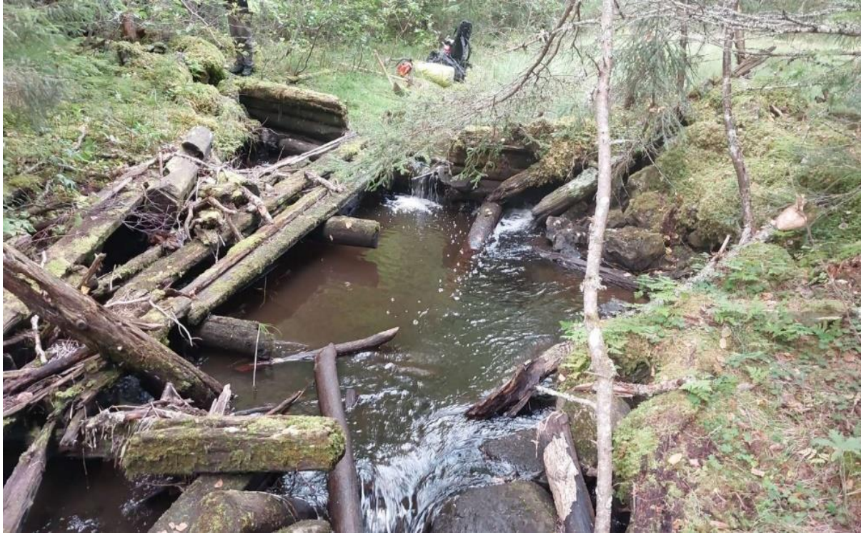
Figur 63. Före restaurering, rester av dammkonstruktion, stenkistor och ränna utgör vandringshinder för fisk, Holmsjöbäcken 2023.
