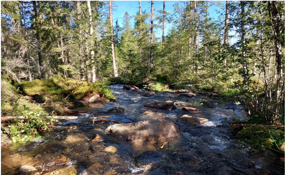
Figur 67. Efter restaurering är Kvarnvallån breddad och större block har blivit återförd till ån. Botten är höjd med en del sprängsten, resterande mängd sprängsten är nedgrävd i kanterna på ån.
