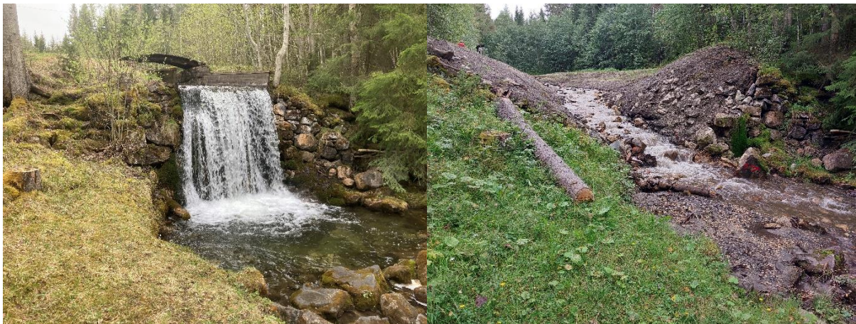
Figur 59. Efter tillståndsansökan påbörjade rivning av dammen i Fillstabäcken sommaren 2023. Utskovsbordet av betong och vandringshindret för fisk togs bort. Till vänster i bild före åtgärd och till höger efter åtgärd.
