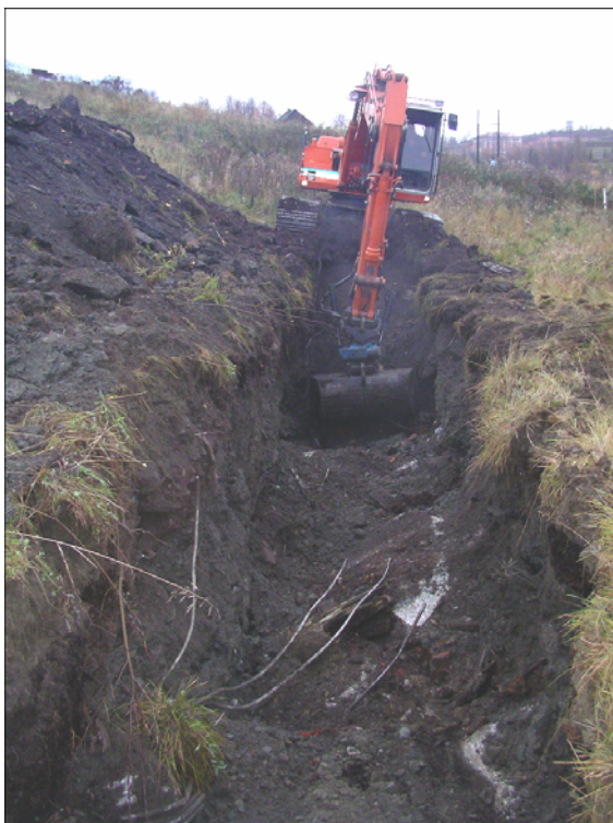
Figur 12. Provgropsgrävning vid punkt PG0501 i slänten av kisaskadeponin/västra slänten. Här söktes förgäves efter kulvert i marken. Grävningen avbröts på grund av mycket omfattande förekomst av betongrester.
