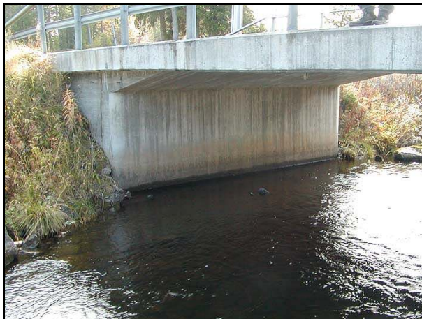
Passage före åtgärd. Ingen strandremsa och inga stenar finns under bron. Dåliga markeringsplatser för utter. Här finns en stor risk att uttern passerar över vägen.
