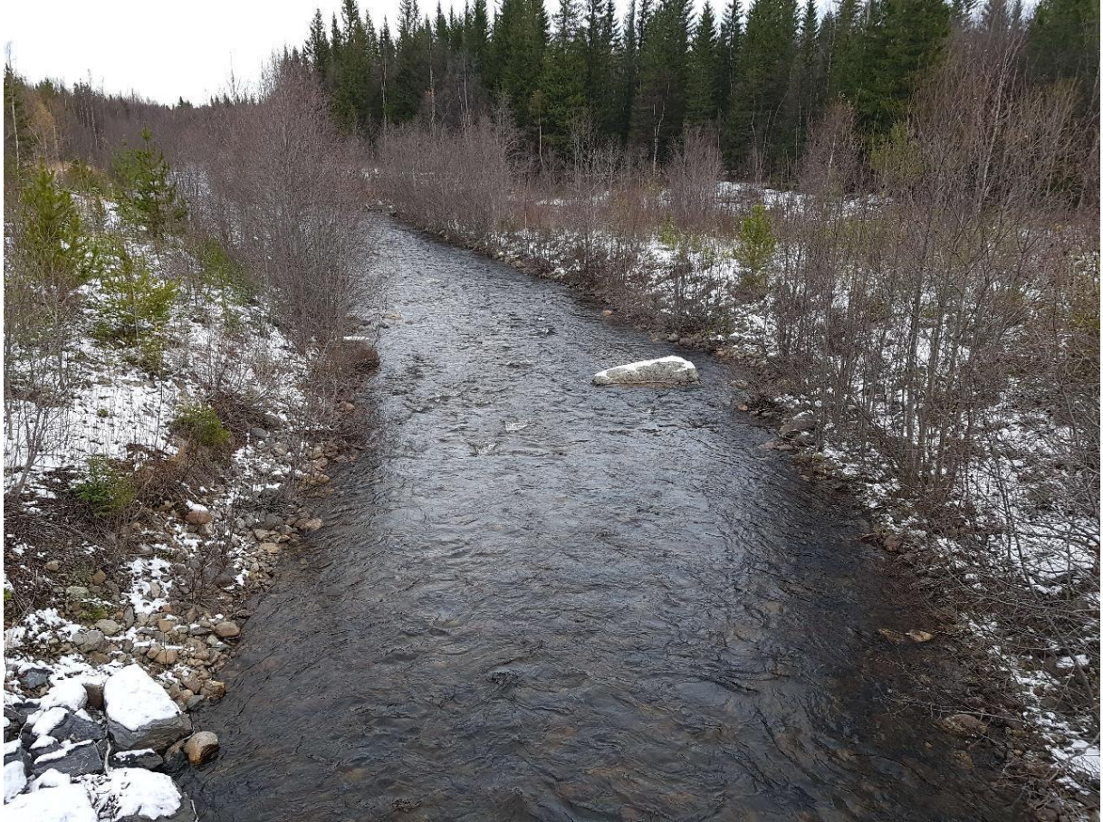
Figur 27. Fotot är taget från bron över Bastuån vid väg 628 mot Gräftåvallen. Bilden visar kanaliseringen av vattendraget nedströms vägtrumman innan åtgärd.
