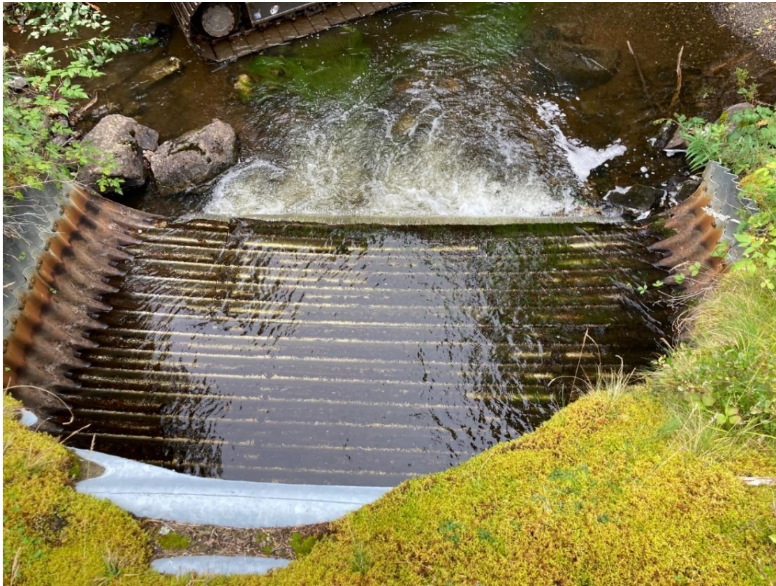
Figur 17. Vägtrumma i Målån före åtgärd, bild tagen ovanifrån
