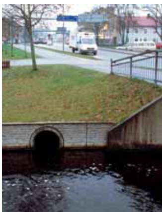
Dagvatten från många städer och samhällen rinner ut i Emån. Bilden visar en dagvattenledning i Vetlanda.
