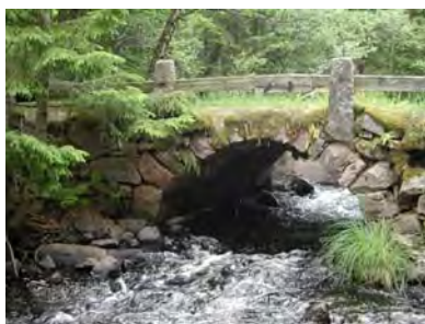
Stenvalvbro i Pauliströmsån, ett biflöde till Emån. Observera det fina broräcket. Bron ligger i en sträcka som ska biotopvårdsrestaureras men berörs ej av åtgärderna. Foto: Lennart Johansson
