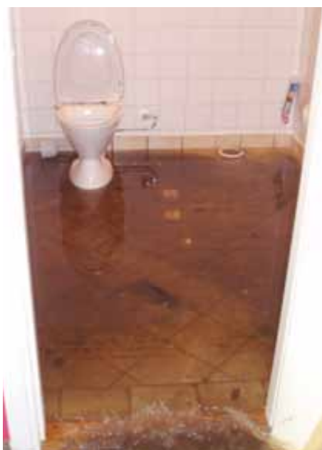
Översvämning på grund av bakåtströmmande avloppssystem i Blekinge 2010. Foto: Daniel Nilsson
