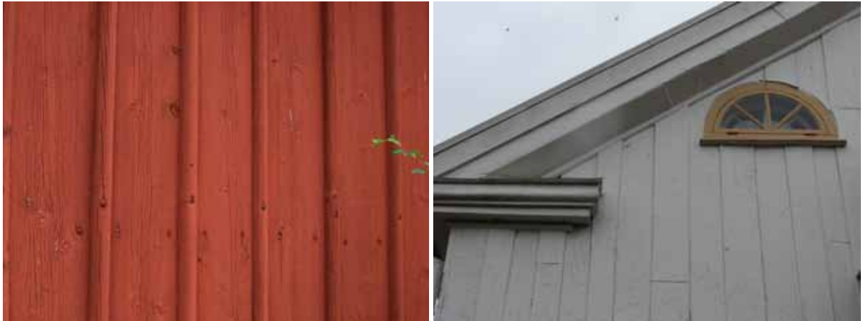
T.v.: I Vimmerbytrakten är det vanligt att man använt halvstavslister på locklistpanelen. Exempel från Frödinge. T.h.: I trakten av Vimmerby är det också förhållandevis vanligt med lockpanel på de äldre mangårdsbyggnaderna. Nära utanför Vimmerby.
