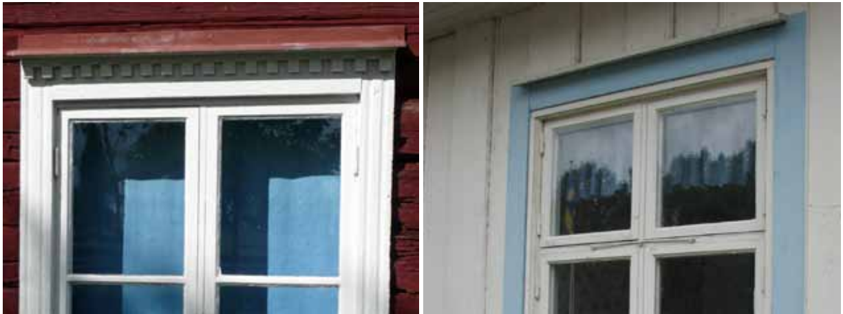
T.v.: Tandsnittsfris ovan fönstren förekommer ofta i Vimmerbytrakten. T.h.: I likhet med Tjust finns det i trakterna av Vimmerby många äldre hus som saknar fönsterfoder. Exempel från Mossebo.
